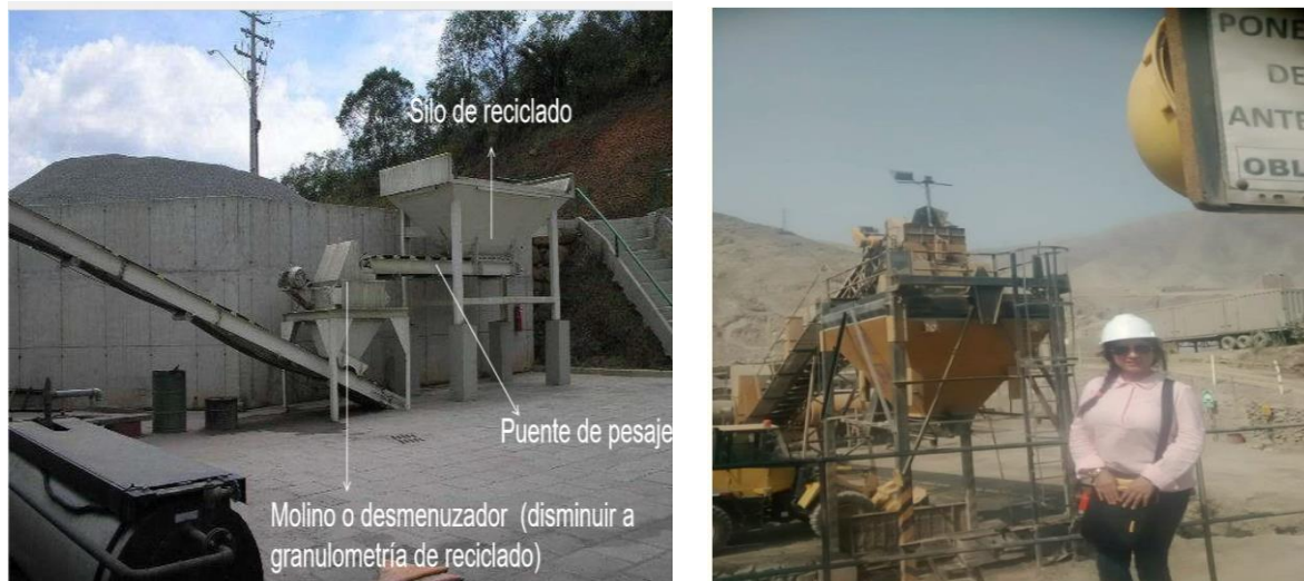
Figura 12: Desmenuzador del RAP-Planta Victoria 2, propia del autor
