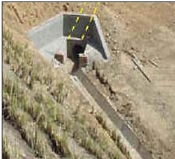
Figura 7. Caja generando cambio de dirección de flujo de agua en talud.
