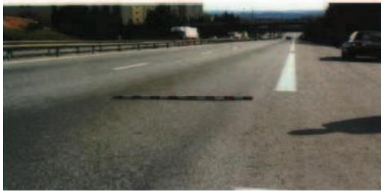
Figura 14: Ahuellamiento – Gravedad 1: Profundidad \leq 6 mm Gravedad 2: Profundidad > 6 mm y \leq 12 mm
