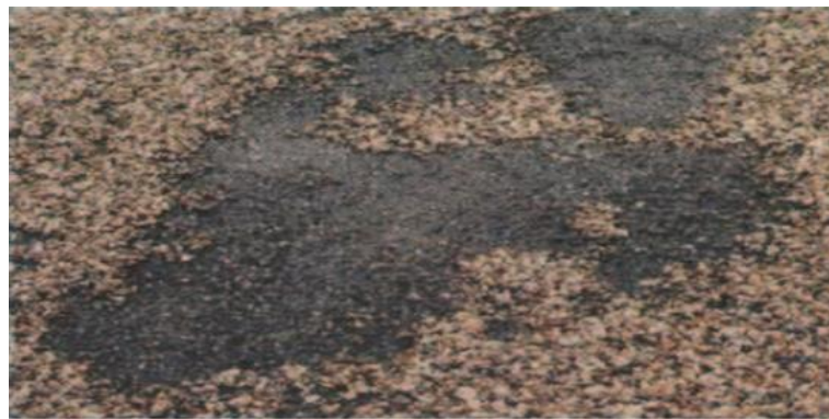
Figura 23: Desprendimiento – Gravedad 3: Continuo con aparición de la base granular
