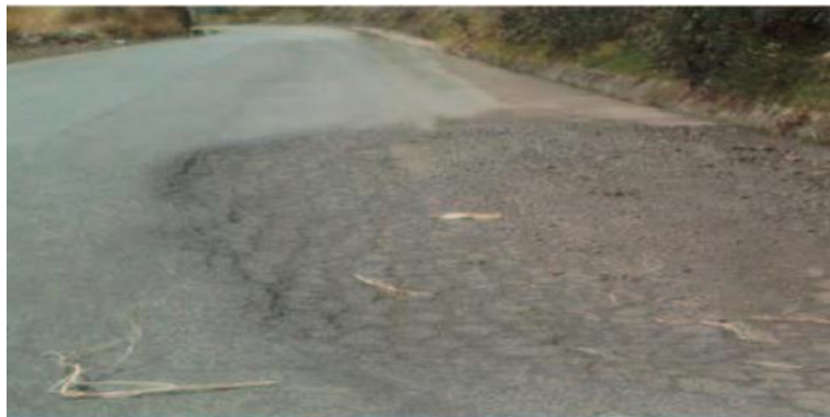
Figura 12: Gravedad 3: Profundidad > 4 cm
