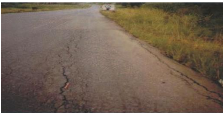
Figura 07: Gravedad 3: Fisuras gruesas, corresponden a fisuras abiertas y/o ramificadas (ancho > 3 mm). También se denominan grietas
