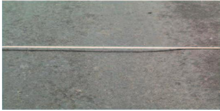
Figura 11: Deformaciones (3b Hundimiento) Gravedad 2: Profundidad entre 2 cm y 4 cm
