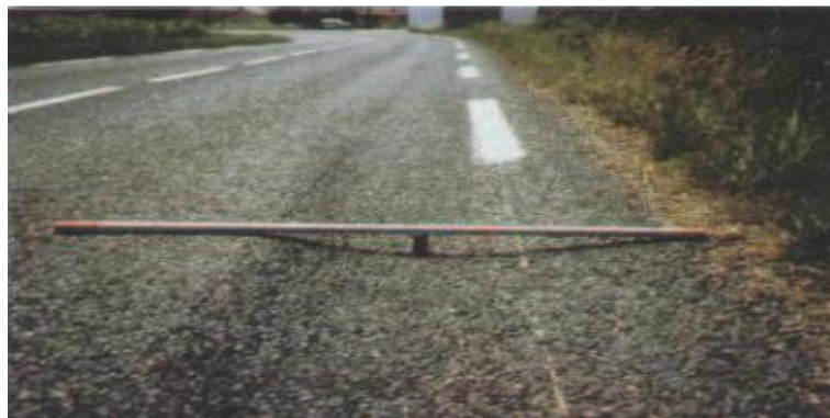
Figura 10: Gravedad 3: Profundidad > 4 cm
