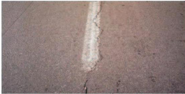
Figura 06: Fisuras longitudinales – Gravedad 1: Fisuras finas en las huellas de tránsito (ancho \leq 1 mm)
