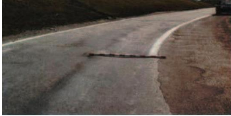
Figura 13: Gravedad 3: Profundidad > 12 mm
