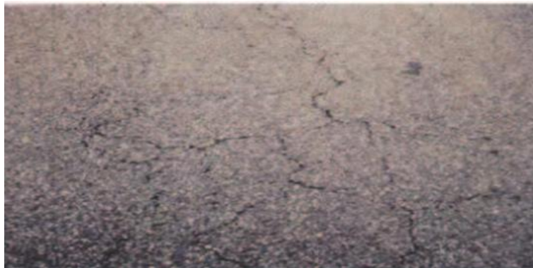
Figura 03: Piel de cocodrilo – Gravedad 1: Malla grande ( > 0.5 m)
