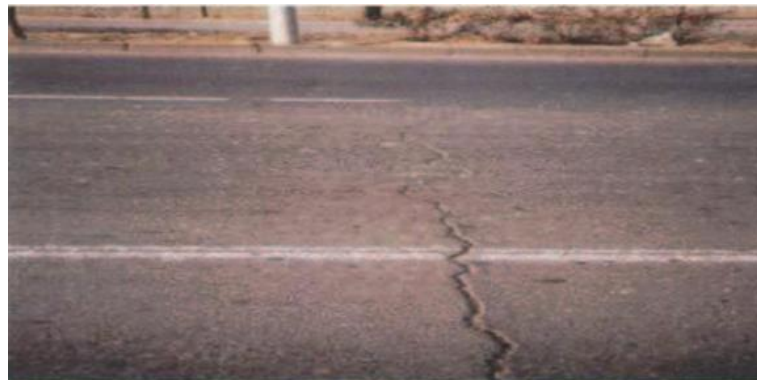
Figura 24: Gravedad 3: Fisuras gruesas corresponden a fisuras abiertas y/o ramificadas (ancho > 3 mm). También denominadas grietas
