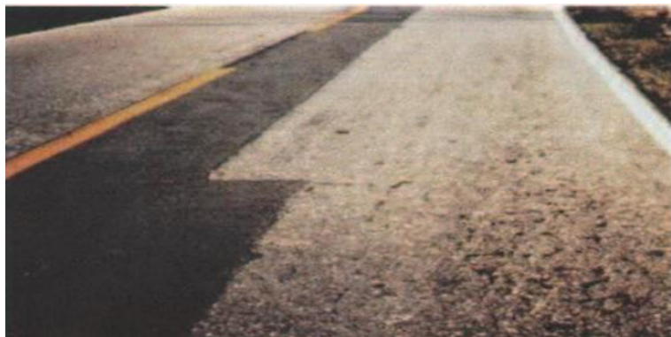
Figura 15: Reparaciones o parchado – Gravedad 1: Reparación o bacheo para deterioros/fallas superficiales
