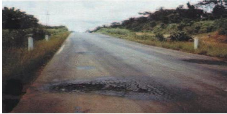
Figura 16: Gravedad 3: Reparación de piel de cocodrilo o de fisuras longitudinales, en mal estado
