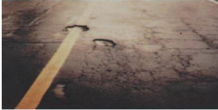
Figura 20: Baches (huecos) – Gravedad 2: Diámetro entre 0.2 y 0.5
