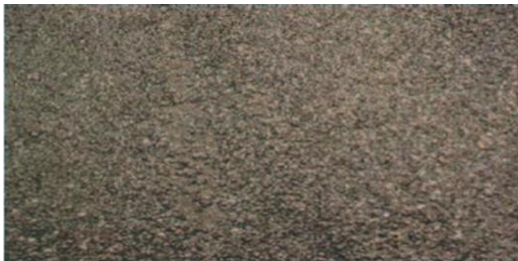
Figura 17: Gravedad 2: Puntual sin aparición de la base granular (desprendimiento del concreto asfáltico)
