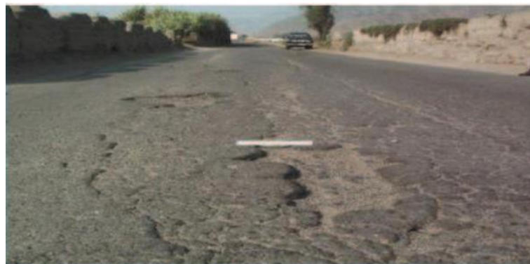
Figura 19: Baches (huecos) – Gravedad 1: Diámetro < 0.2 m
