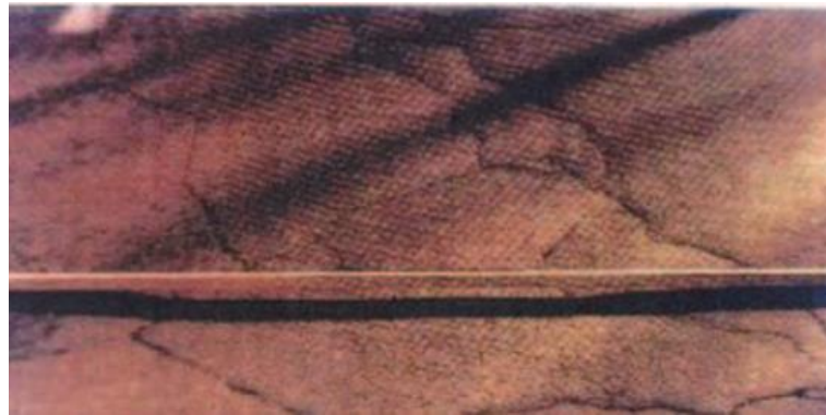
Figura 09: Deformaciones – (3ª depresión continua longitudinal) – Gravedad 1: Profundidad entre 2 cm y 4 cm
