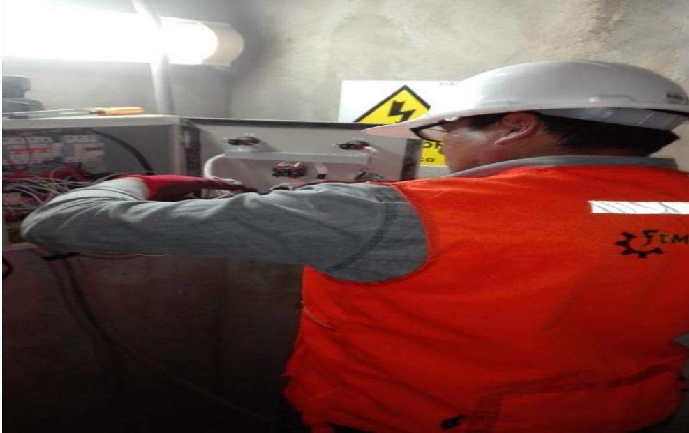
Anexo 3. Manejo de cajas elèctricas
