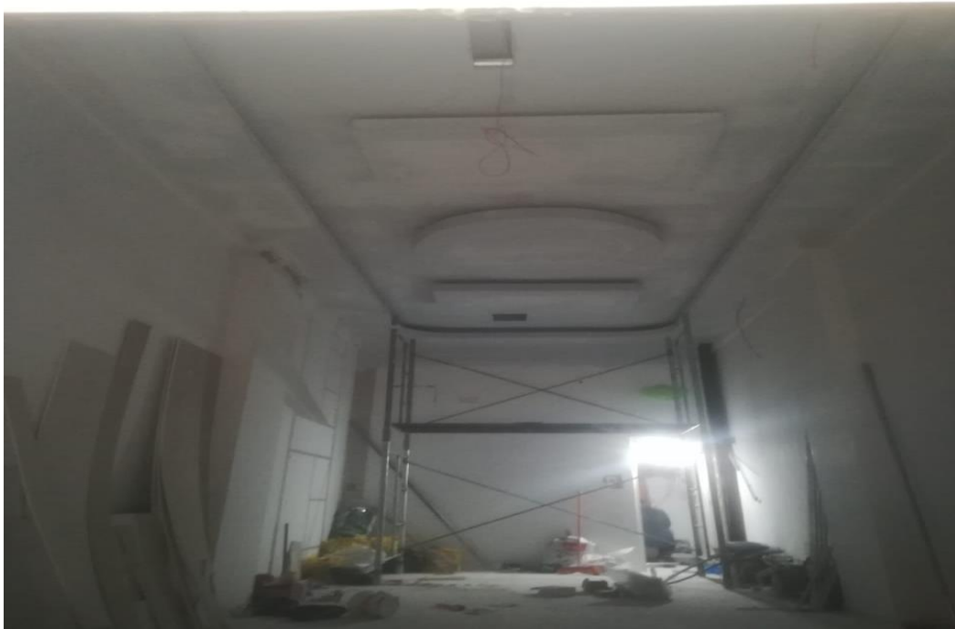
Anexo 6. Áreas de trabajo inadecuadas
