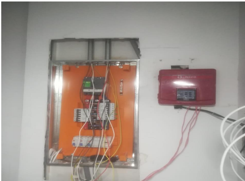
Anexo 12. Instalaciones en piso
