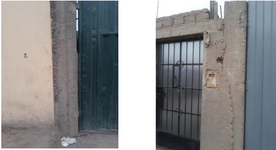
FIGURA 9. Viviendas sin junta sísmica Fuente: Propia
