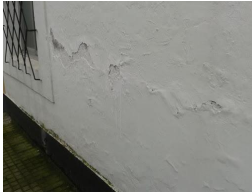
FIGURA 7. Muros portantes y no portantes con humedad Fuente: Propia
