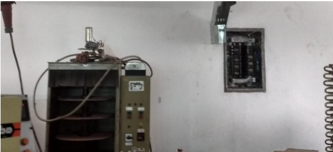
Figura 4: Exposición a riesgo eléctrico
