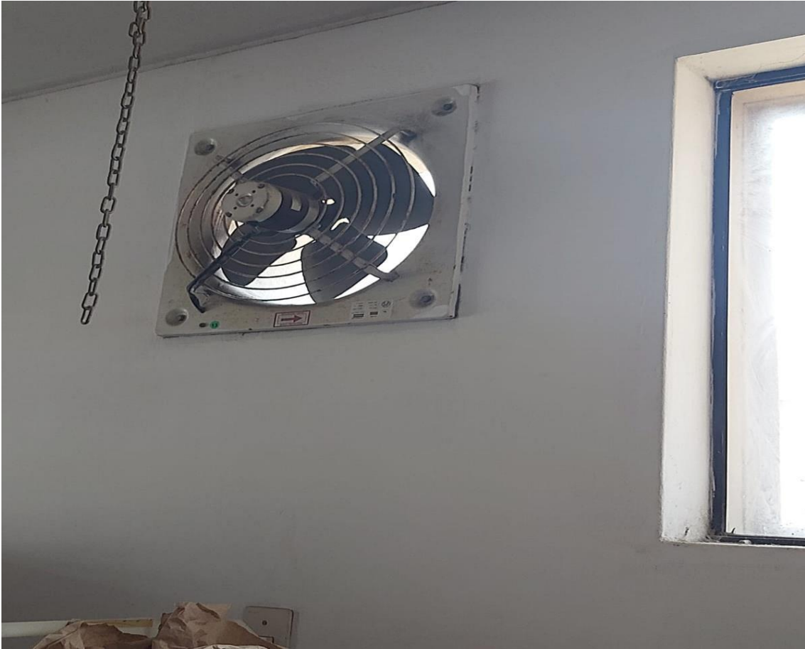
Figura 9: Se realizó mantenimiento preventivo a extractor de aire
