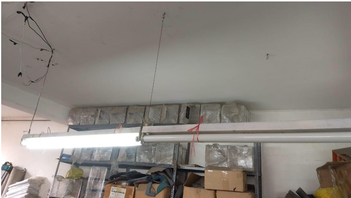
Figura 6: Riesgo por golpe y exposición de cables
