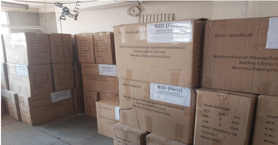
Figura 7: Obstrucción de camino por mercadería y exposición de cables
