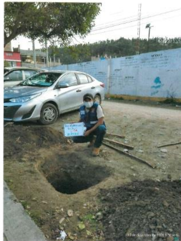
Foto N° 4: Se puede apreciar en la imagen la Av. Peru en la cuadra 07, la Calicata N° 04
