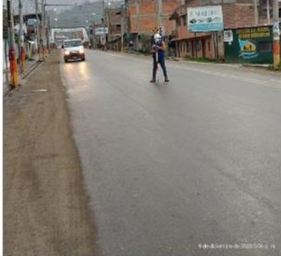
Fotografía N°3: Se puede apreciar el levantamiento topográfico realizándose en la quinta y sexta cuadra de la avenida Perú.
