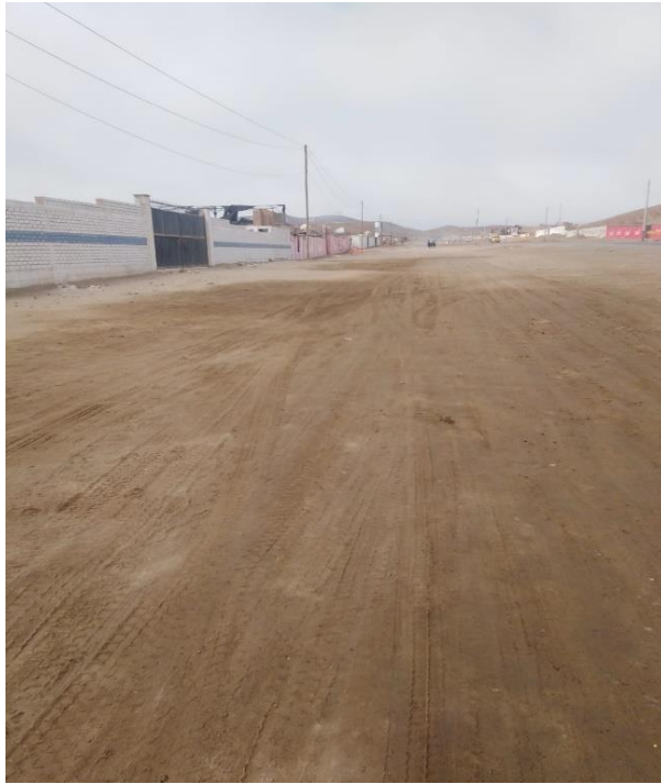
Fotografía 20. Tramo progresiva 2+350.00 sin pavimentar.
