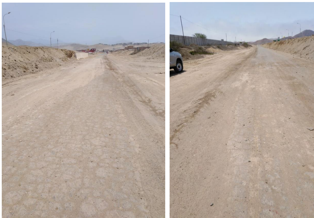
Fotografía 19. Tramo progresiva 1+350.00, pavimento con daños severos.
