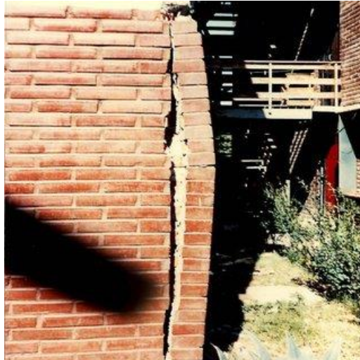
Figura 2: Grietas en muros.
