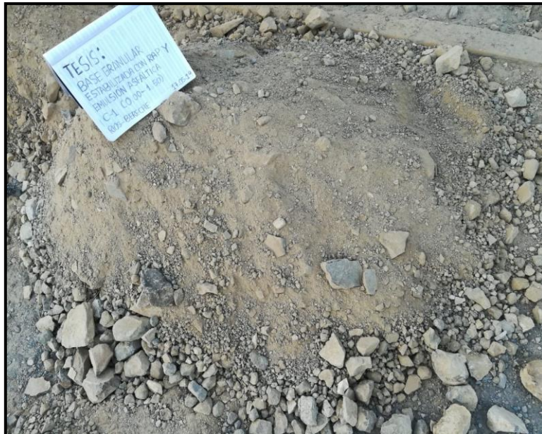
Fotografía N° 26: Base granular extraída
