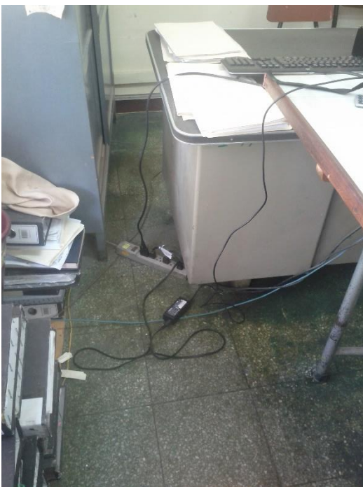
Riesgo de Fuego e incendio de recursos físicos. Fuente: GRP
