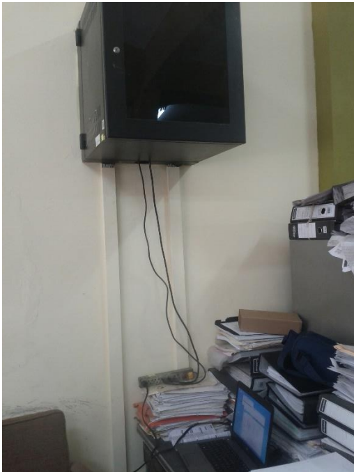
Riesgo de Fuego e incendio al rack de pared y sus componentes. Fuente: GRP
