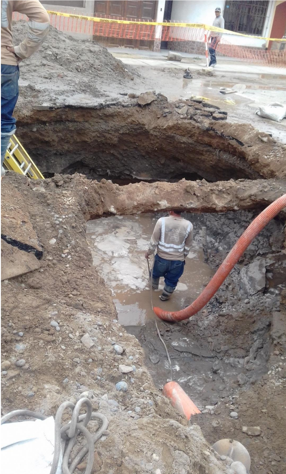
Foto: Fuga en Tramo de Redes
