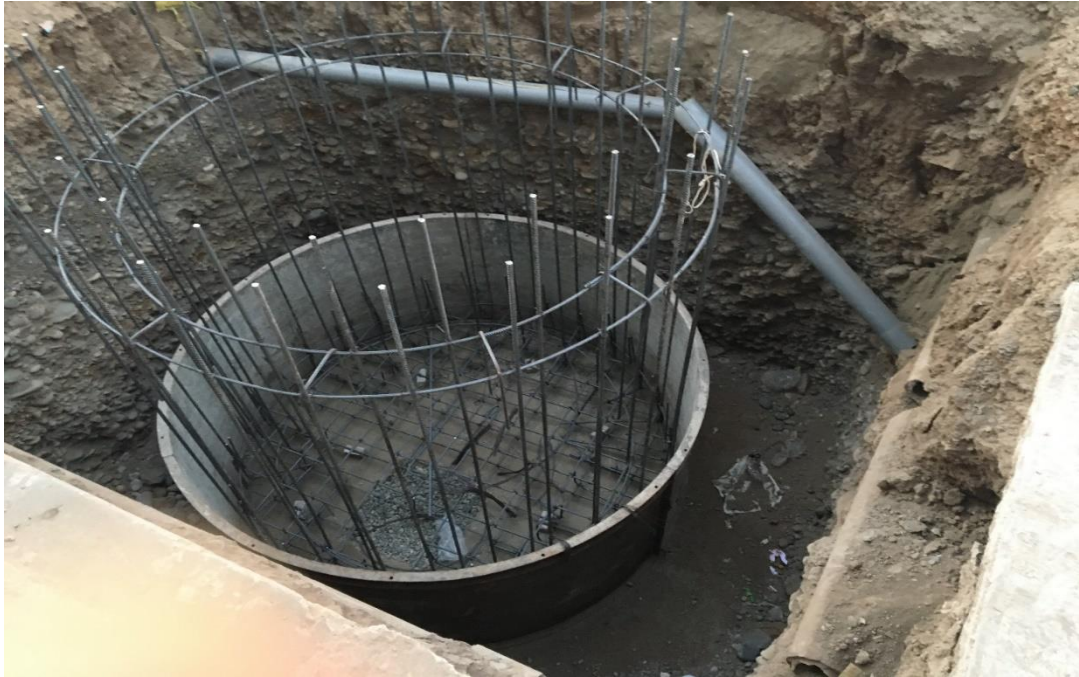
Foto N°5 Cámara de inspección (Buzón)
