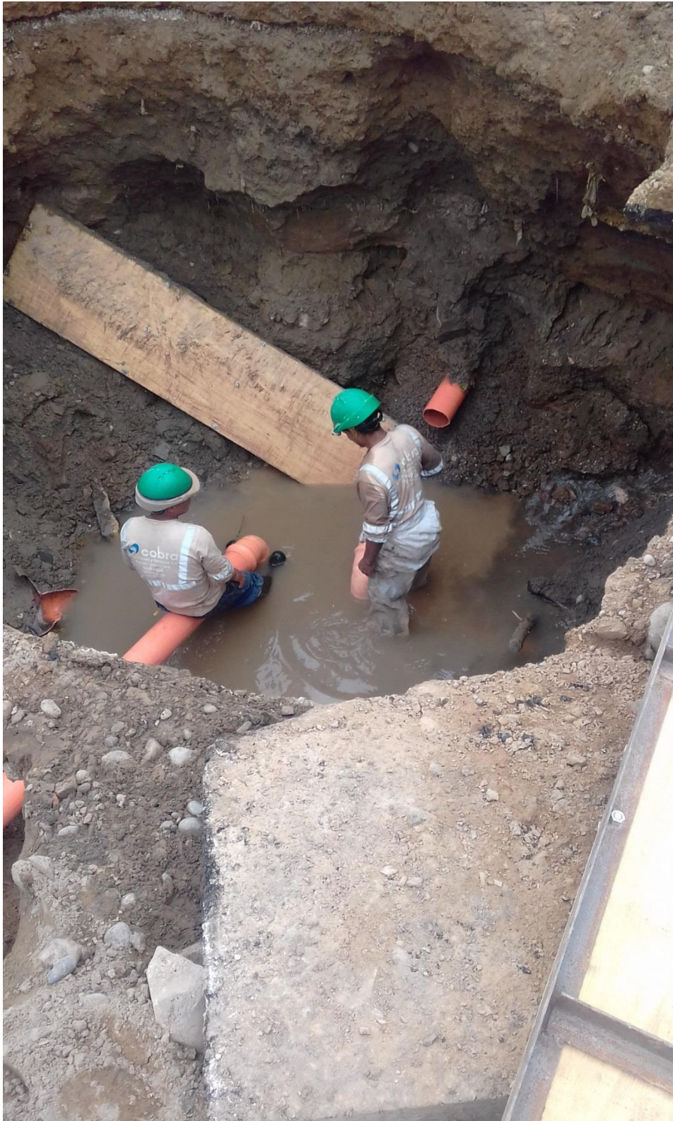
Foto: Atoro de Red de Alcantarillado
