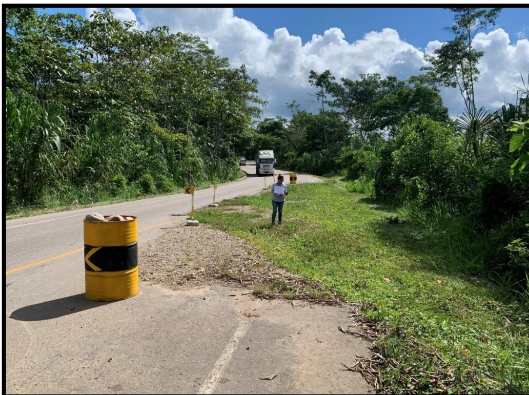
Ilustración 28: Séptima Falla Crítica - Falla no catalogada por el PCI.
