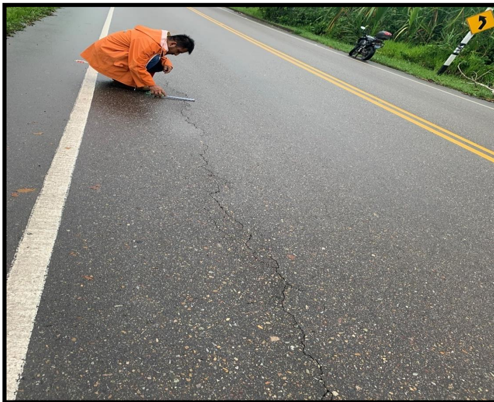
Ilustración 15: Grietas Longitudinales y Transversales
