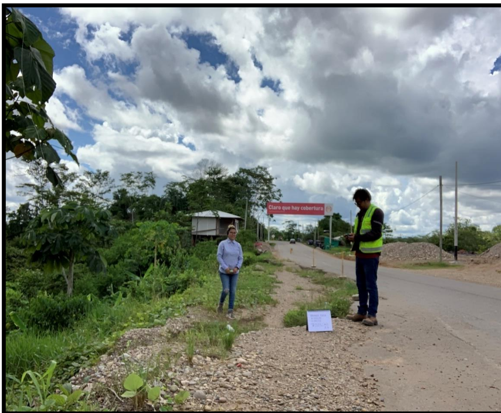
Ilustración 22: Primera Falla Crítica - Falla no catalogada por el PCI.
