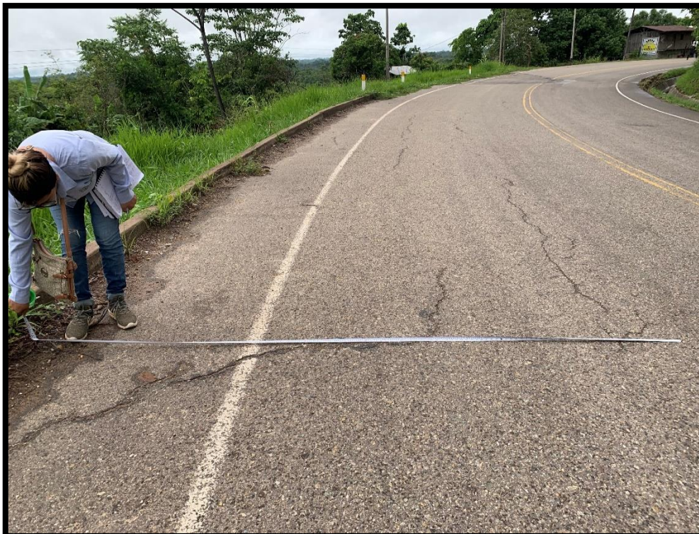
Ilustración 10: Agrietamiento en Bloque
