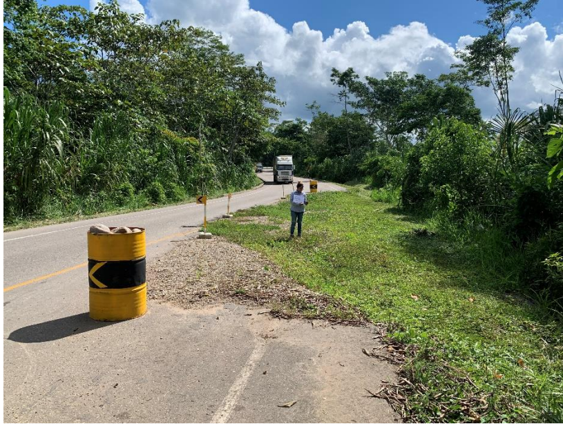
Figura N° 1 Carril colapsado en sentido NE-SO. Fuente: Elaboración propia.
