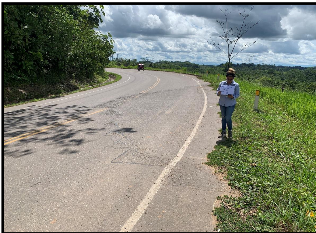
Ilustración 23: Segunda Falla Crítica - Falla no catalogada por el PCI.
