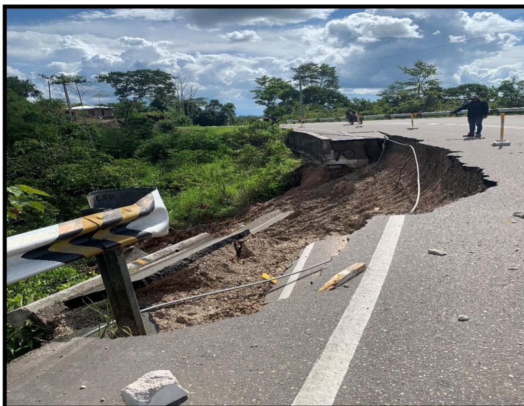
Ilustración 29: Octava Falla Crítica - Falla no catalogada por el PCI.
