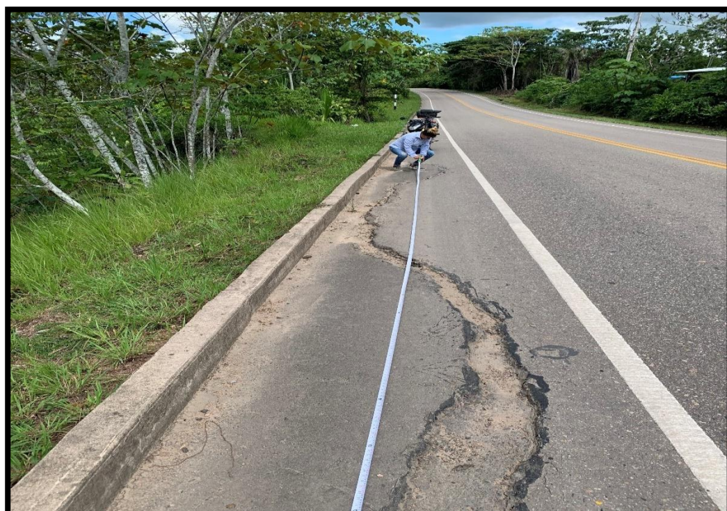
Ilustración 25: Cuarta Falla Crítica - Falla no catalogada por el PCI.
