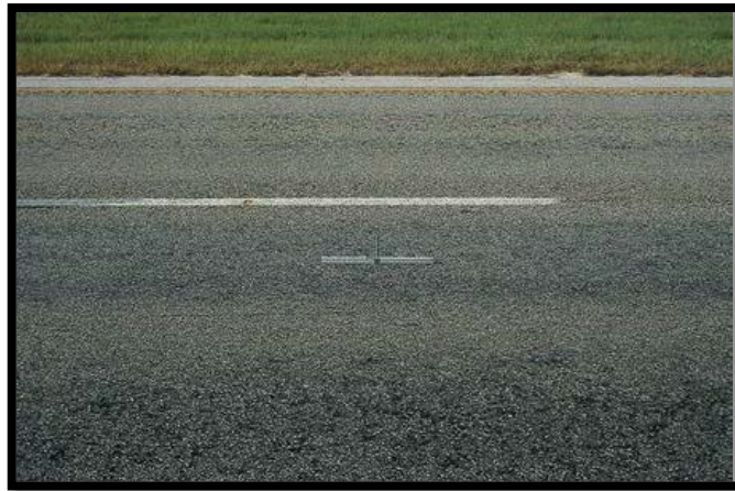
Figura N° 7 Nivel Bajo (2L). Fuente: FHWA-HRT-13-092, 2014, p.26.
