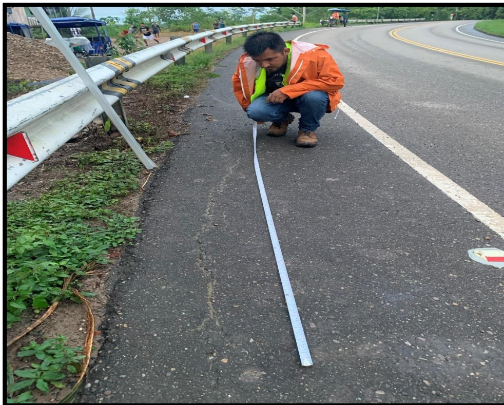
Ilustración 13: Grietas de Borde
