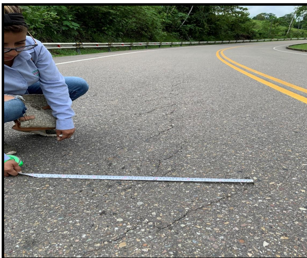
Ilustración 20: Grietas Parabólicas o por Desplazamiento.
