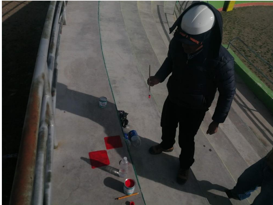
Imagen N° 01 Se observa pintado de BMS ubicación plaza toros Pisacoma
