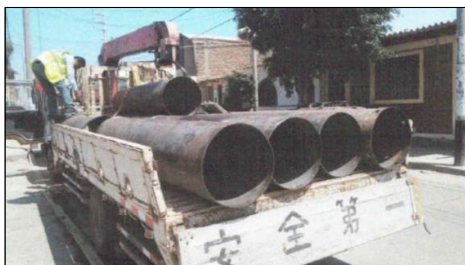
Figura 17. Tubería de Ciega de Acero
