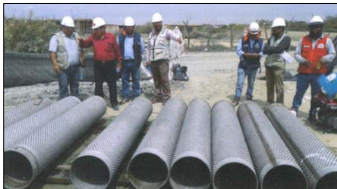
Figura 16. Tubería de Filtro
