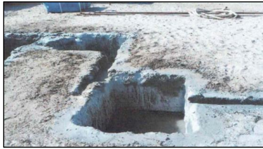
Figura 12. Pozas de Circulación de lodos.
