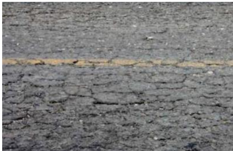
Figura 4. Formación de piel de cocodrilo en pavimento flexible
