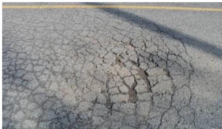
Figura 6. Grietas de bloque o contracción
