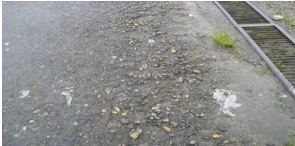
Figura 9. Pulimento y desprendimiento del agregado
