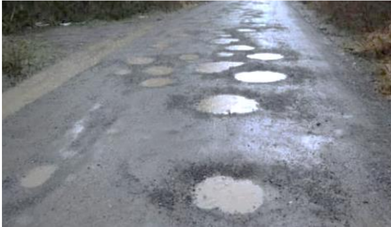
Figura 8. Depresiones circulares en la superficie del pavimento
