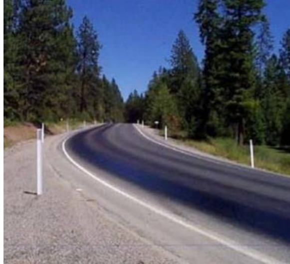
Figura 5. Manchas en pavimentos flexibles (Exudación)
