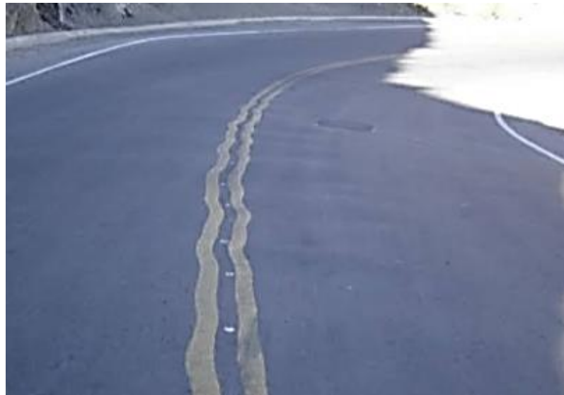
Figura 7. Formación de corrugación en la superficie del pavimento
