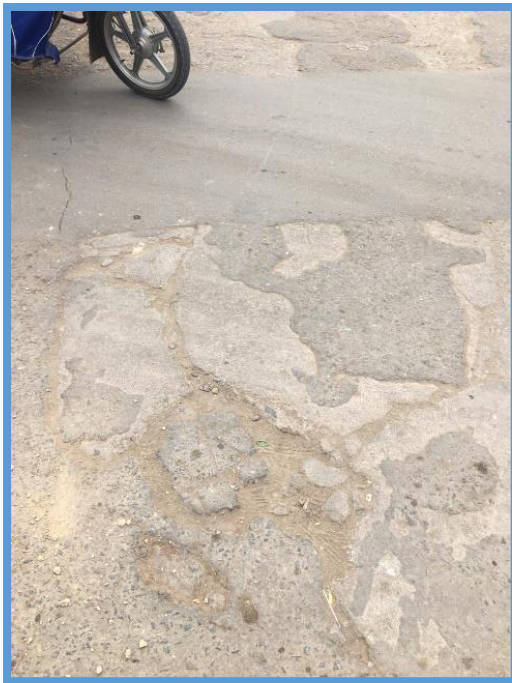
Fg 14. Desprendimiento de agregados severidad alta -Muestra N°3.
