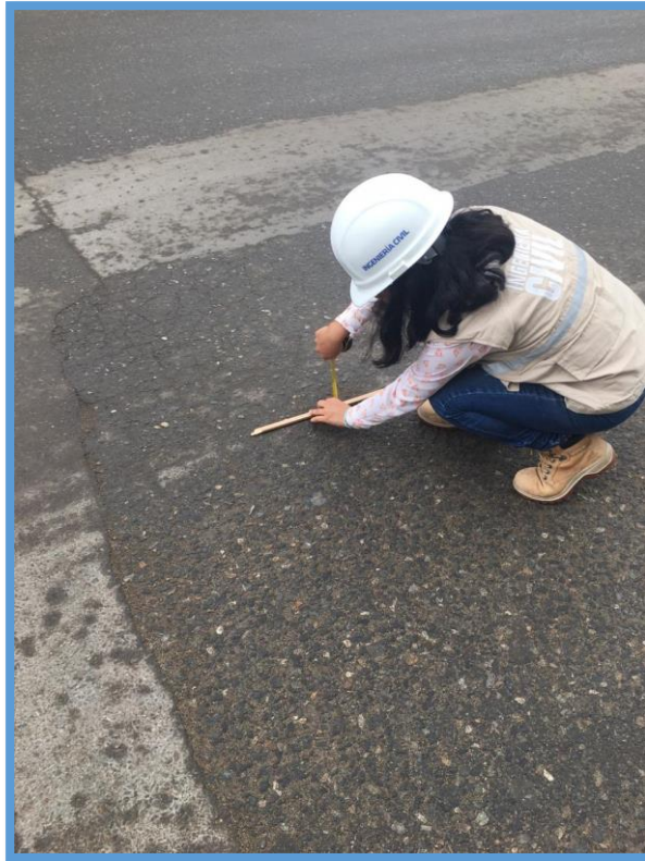
Fg 6. Medición de la profundidad del bache o hueco.
