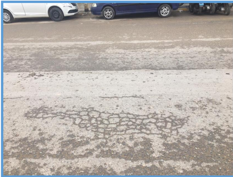
Fg 11. Falla piel de cocodrilo severidad alta-Muestra N°2.
