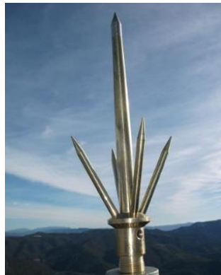
Figura 9 Parte superior de la torre donde se encuentra el pararrayo
