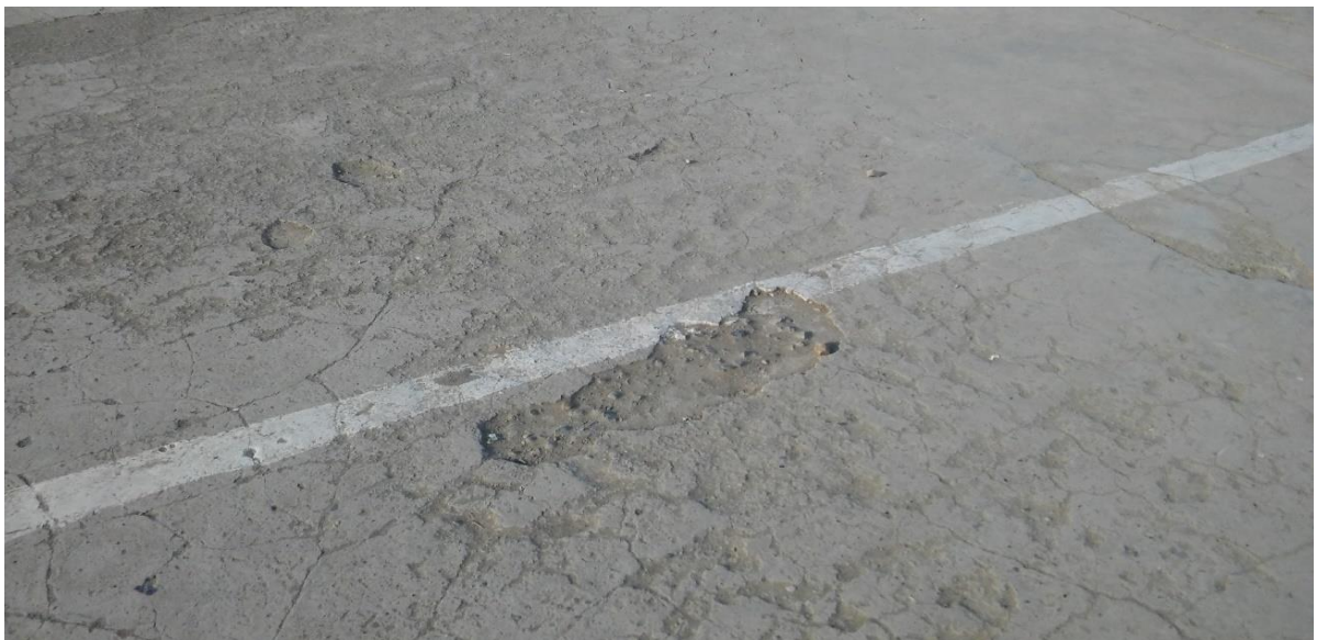
Figura 98. Deterioro de losa deportiva
