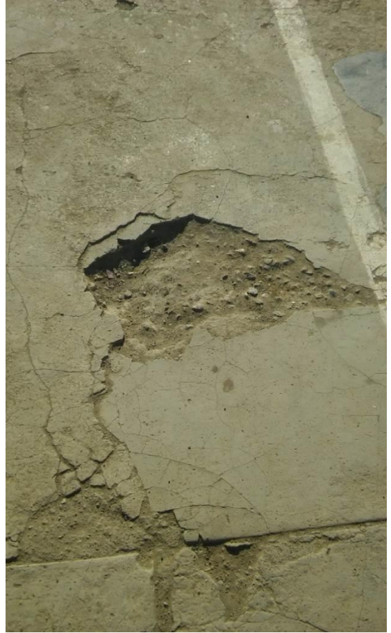
Figura 97. Deterioro de losa deportiva
