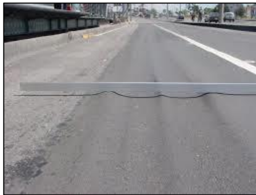
Figura 7. Deformación por deficiencia estructural.
