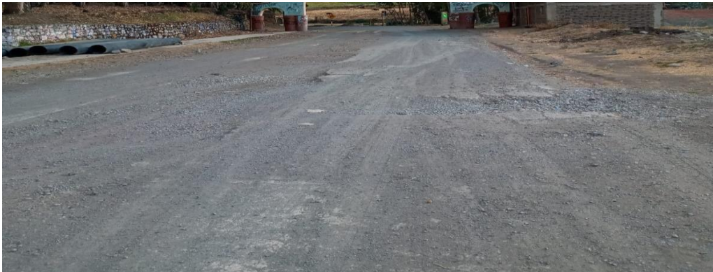
FIGURA 5 – DESPRENDIMIENTO DEL AGREGADO
