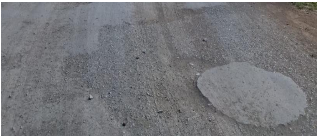
FIGURA 6 – DESPRENDIMIENTO DEL AGREGADO II
