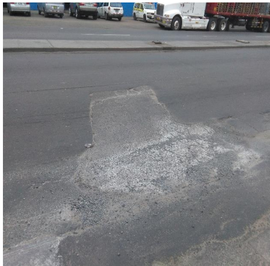
Figura 1. Estado del pavimento de la Av. Argentina.
