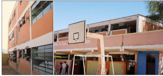
Figura 1: Daños en el estructural dual durante el terremoto de Pisco (2007). FUENTE: San Bartolomé y Quin (2010).
