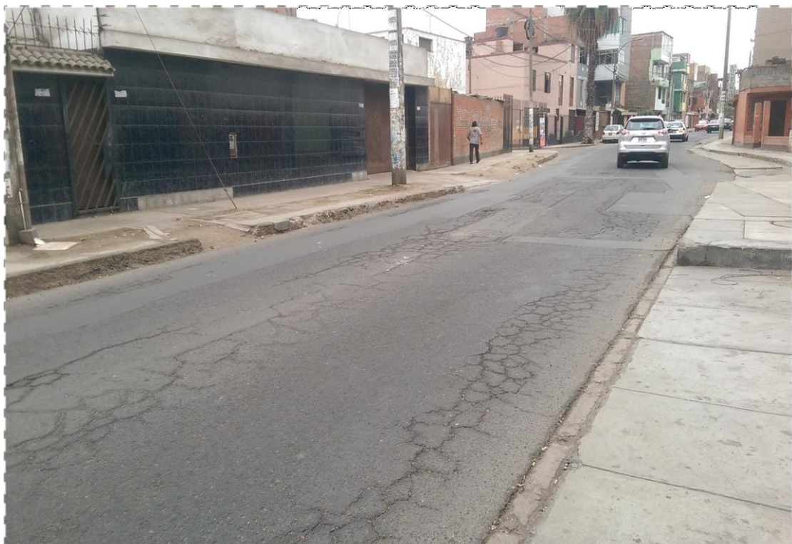
Toma 02.- Se muestra el deterioro del Pavimento de la Av. Venus hacia el tramo Jr. Los Chasquis.
