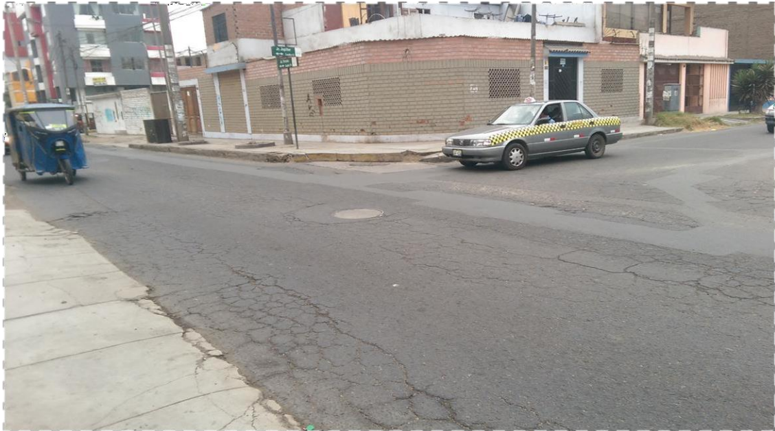
Toma 01.- Falla estructural que deteriora el Pavimento en la Av. Venus
