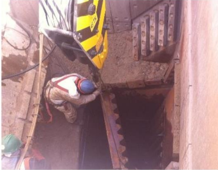
Figura 1. Instalación de Mandíbula Fija en Chancadora Jaque 80x90.
