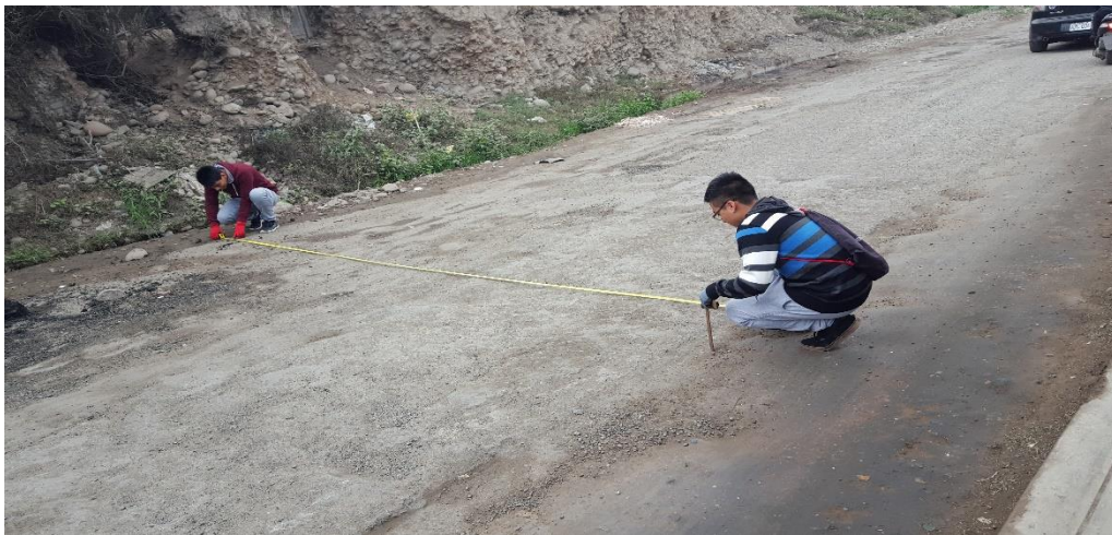
Imagen 6: Falla por bacheo
