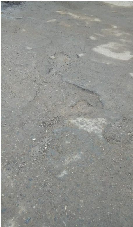
Imagen 3: Falla por bacheo
