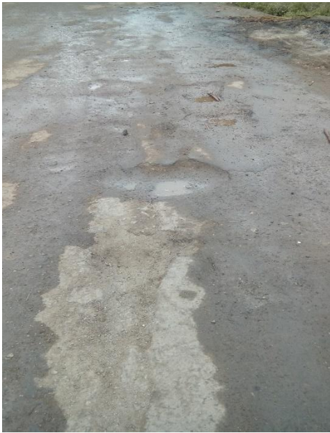
Imagen 1: Falla por bacheo
