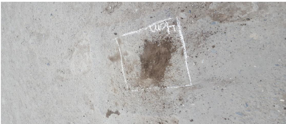
Imagen 12: Falla por bacheo
