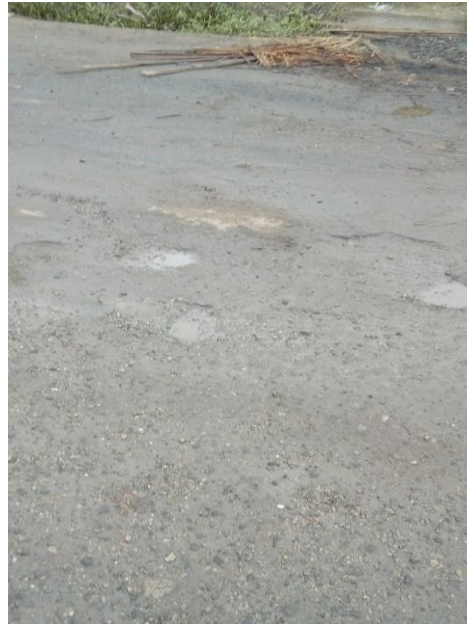
Imagen 2: Falla por bacheo
