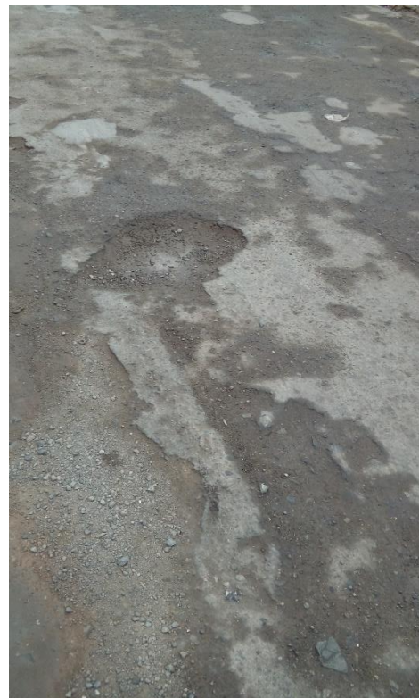
Imagen 4: Falla por bacheo
