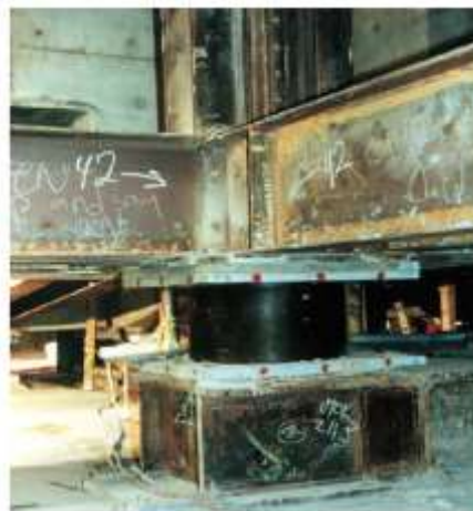
Figura 18. Columna y vigas metálicas sobre aislador
