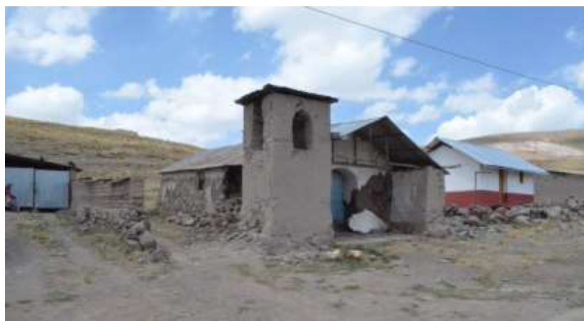
Figura 3. Iglesia dañada por el sismo ocurrido en Lampa
