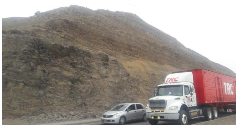
Figura 15. Riesgo de la inestabilidad. (Fuente: Imagen propia, 2019)
