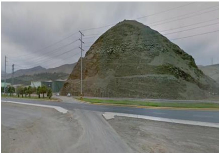
Figura 2. Estado actual del talud en la Av. Néstor Gambetta – La Pampilla. (Fuente: Imagen propia, 2019)
