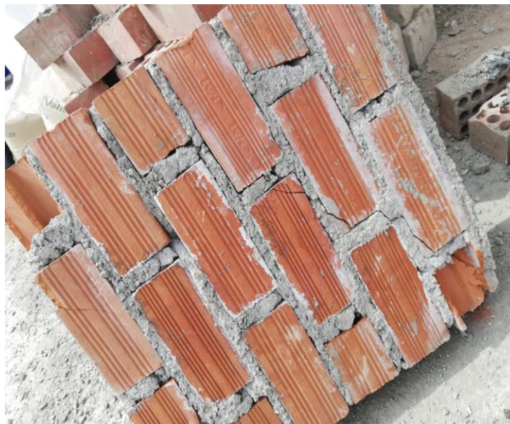
Figura 40: Murete presenta falla por corte diagonal en las juntas.
