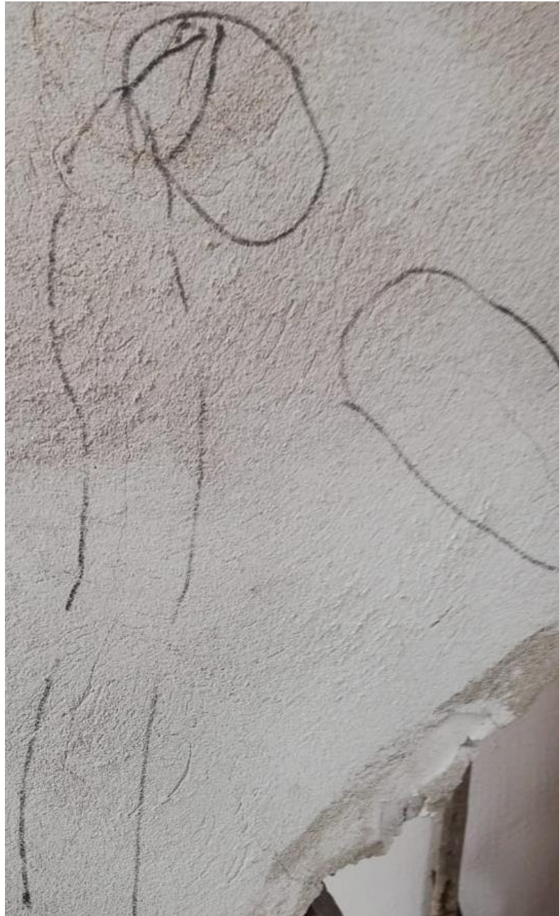
Figura 44: Murete presenta falla por corte diagonal con pequeñas fisuras verticales de 0.5mm.
