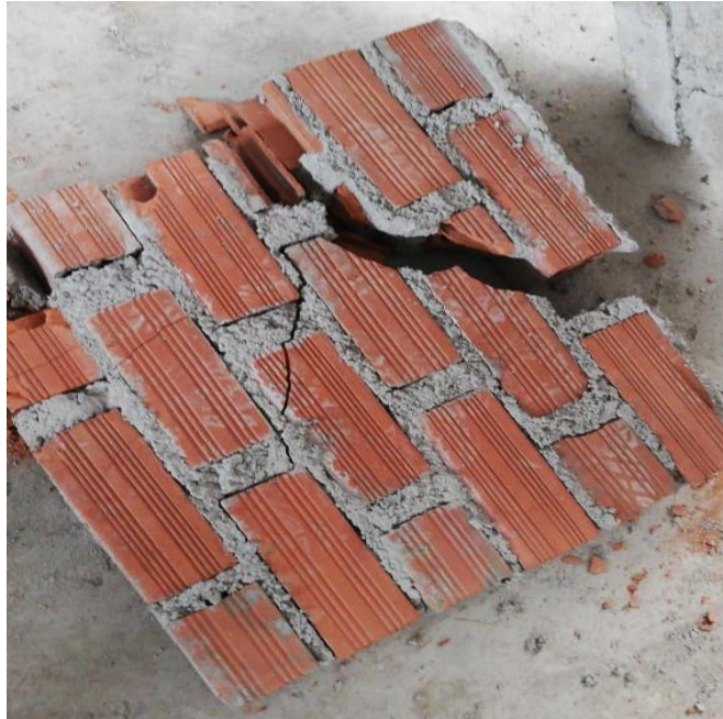
Figura 41: Murete presenta falla por corte diagonal en bloques
