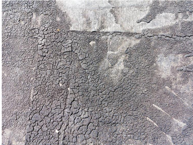
Figura 7. Erosión del concreto.
