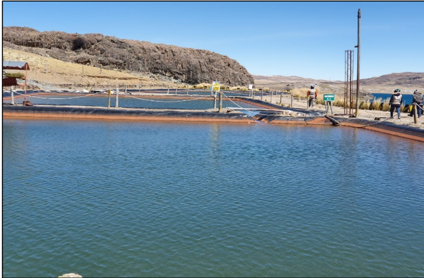
Figura 5. Planta de Tratamiento de Aguas de Mina (PTAM) Beatricita
