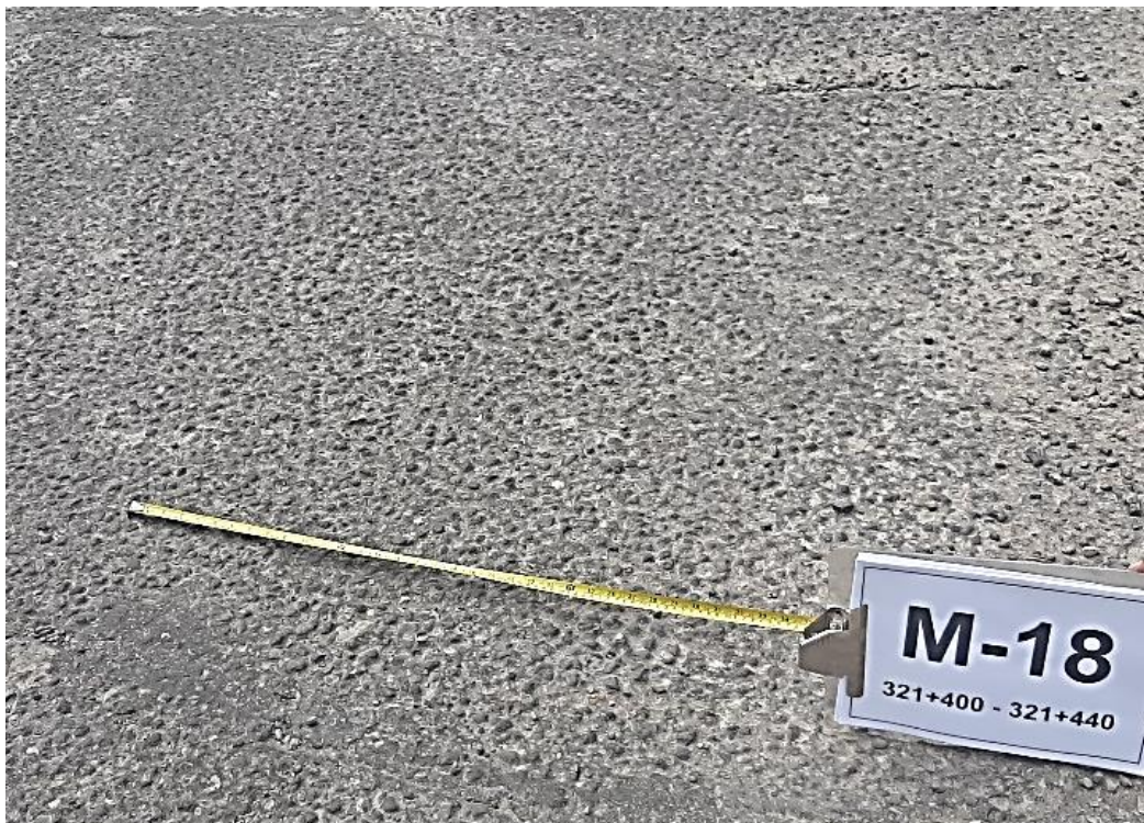
Figura N° 27: Falla tipo meteorización/desprendimiento de agregados
