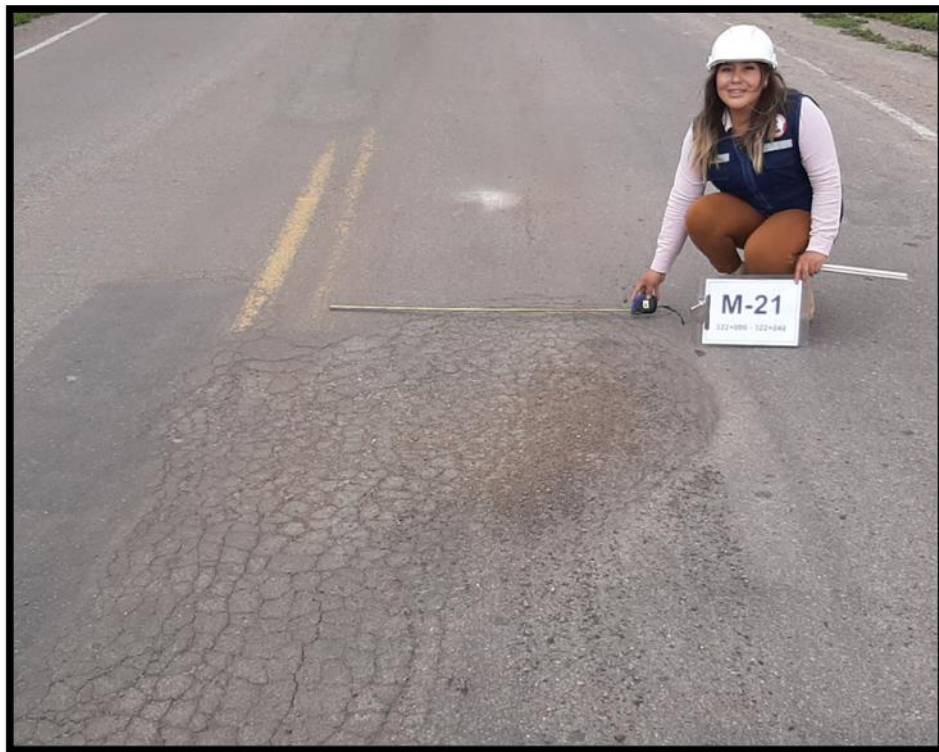
FOTO N°04: Tipo de Falla tipo piel de cocodrilo en la via Libertadores.
