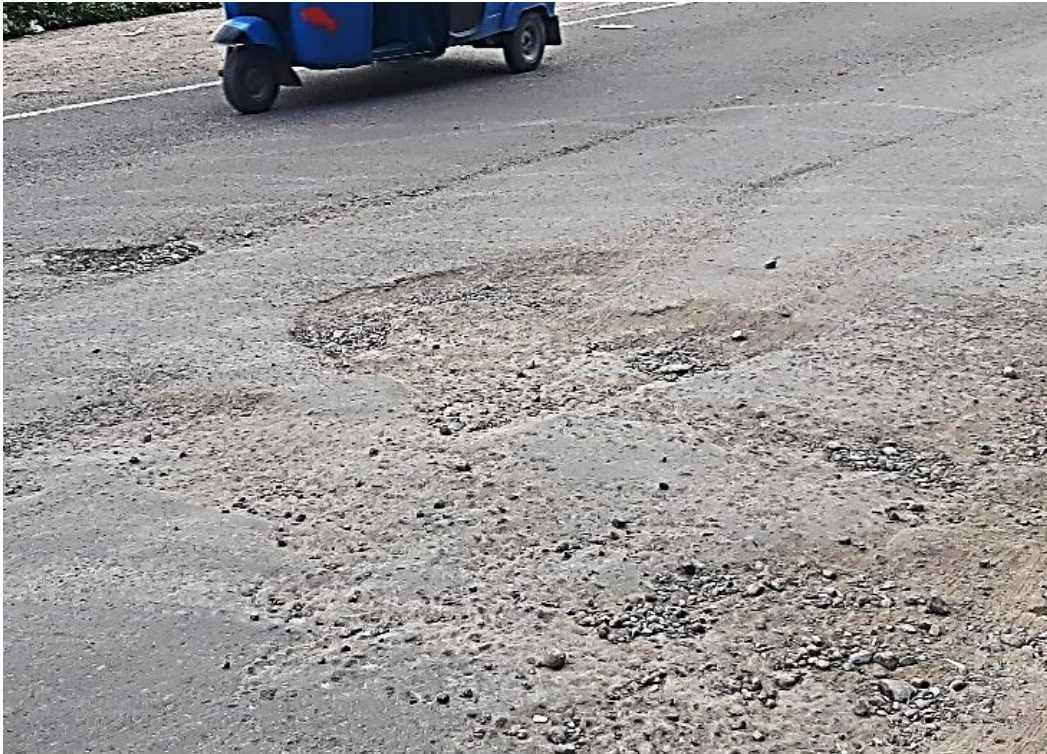
Figura N° 21: Falla tipo Huecos
