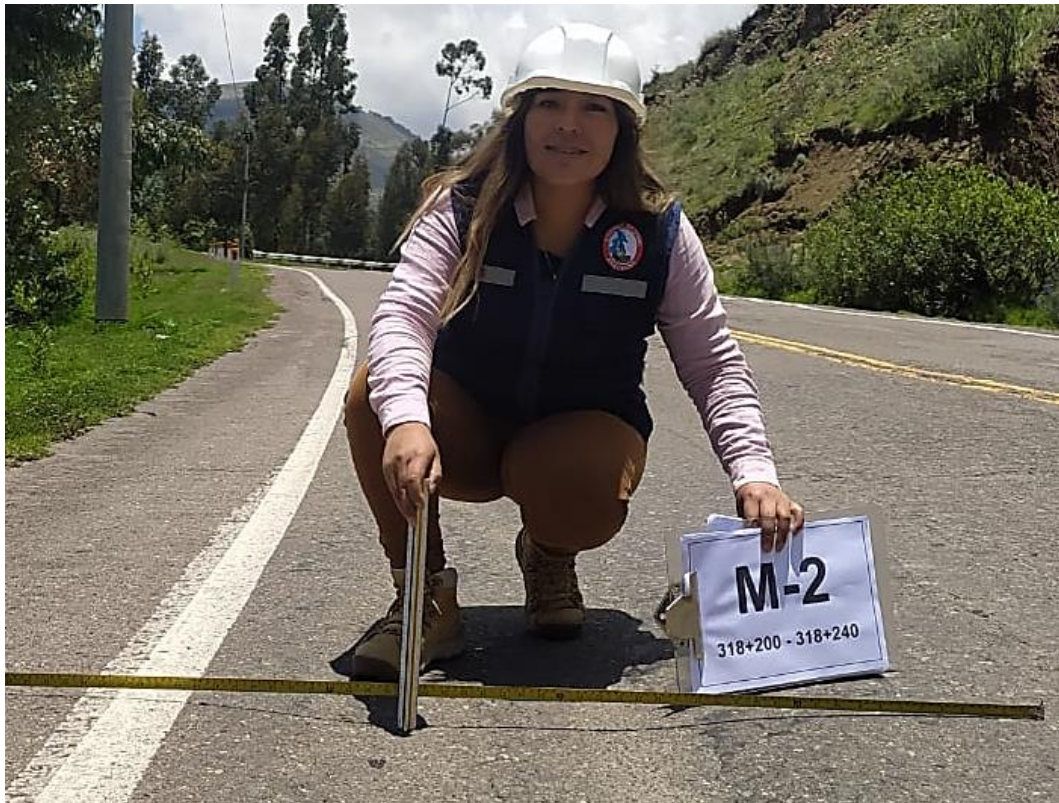
Figura N° 13: Falla tipo depresión
