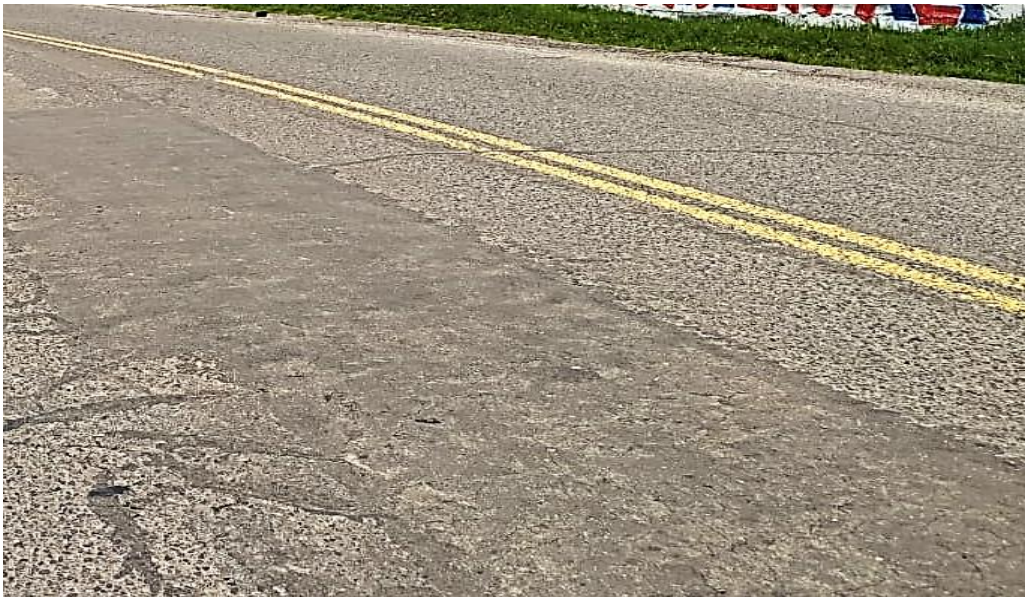
Figura N° 19: Falla tipo parches
