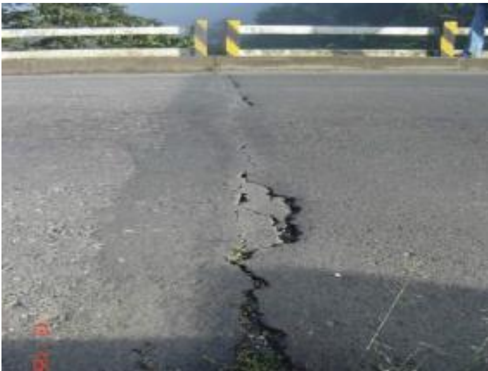
Figura N° 15: Falla tipo Grieta de reflexión de junta
