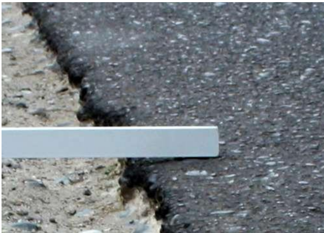
Figura N° 16 Falla tipo de desnivel de carril
