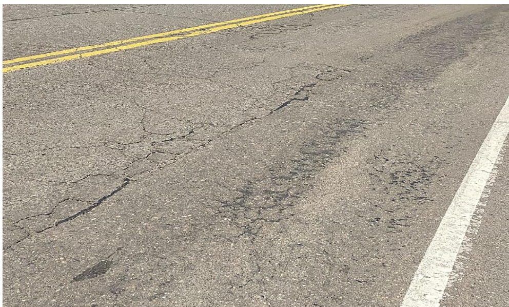
Figura N° 08 Falla tipo Exudación.
