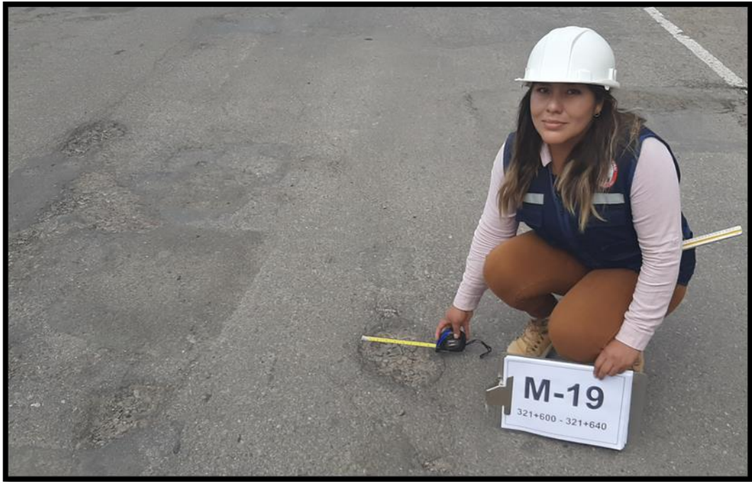
FOTO N°11: Falla tipo Huecos, en la vía Libertadores
