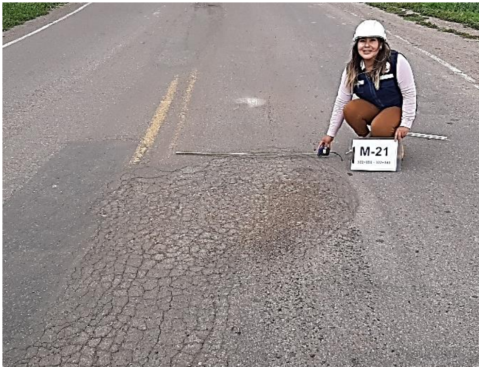
Figura N° 07 Falla tipo piel de cocodrilo.
