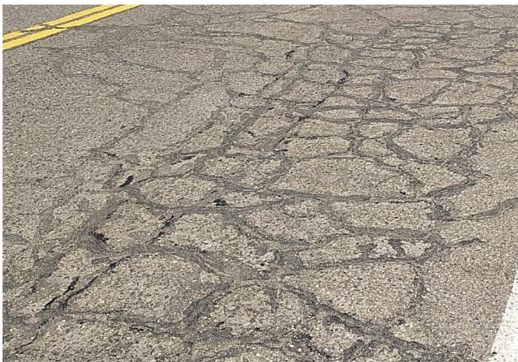
Figura N° 09 Falla tipo agrietamiento en bloque.
