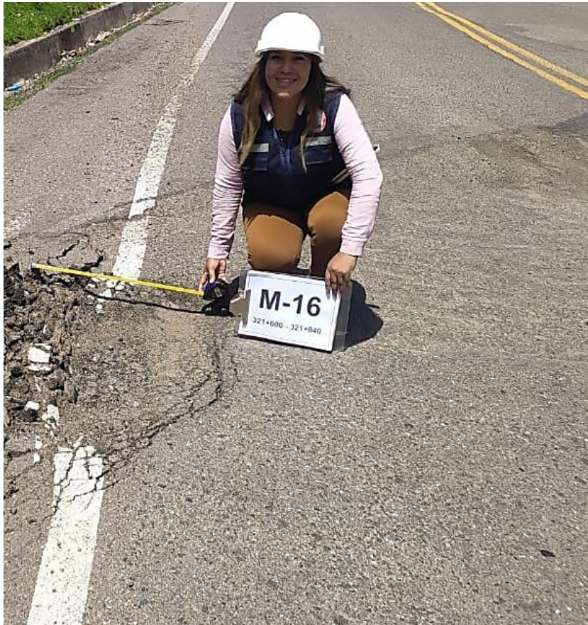
Figura N° 25: Falla tipo grietas parabólicas
