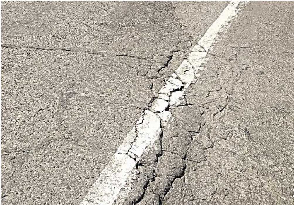
Figura N° 14 Falla tipo Grietas de borde
