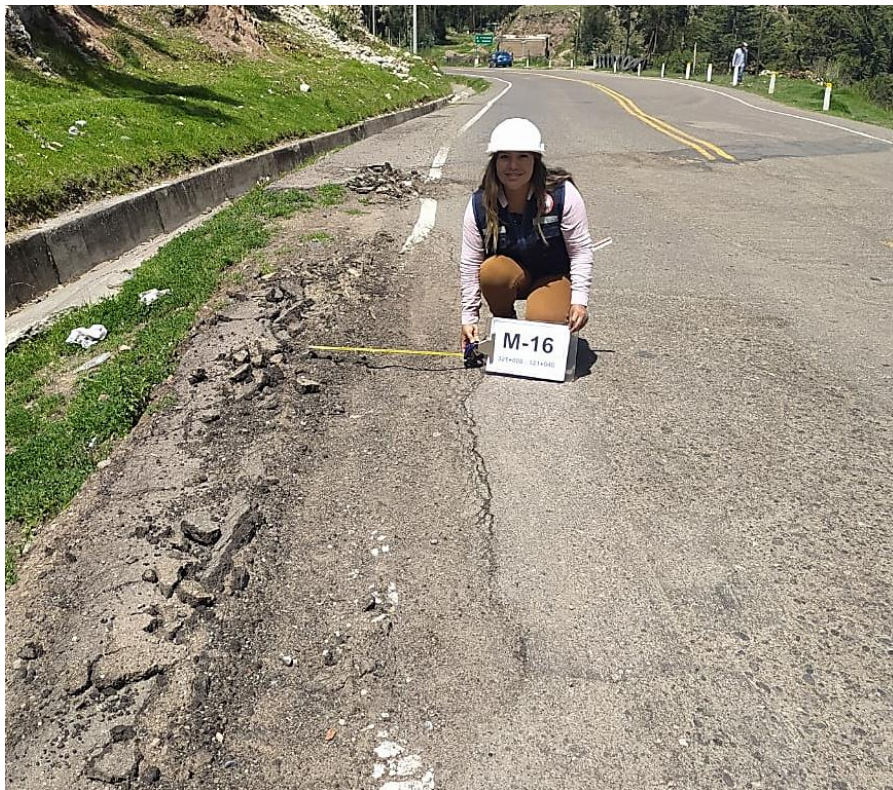
Figura N° 26: Falla tipo hinchamiento
