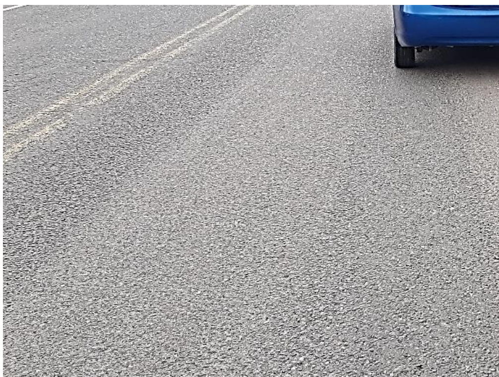
Figura N° 20: Falla tipo pulimiento de agregados
