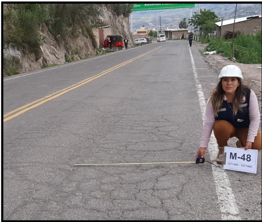
FOTO N°06: Falla tipo agrietamiento en bloque.
