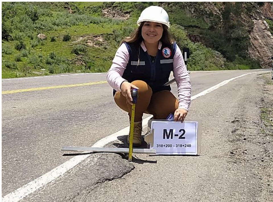
Figura N° 10 Falla tipo Abultamiento y hundimientos
