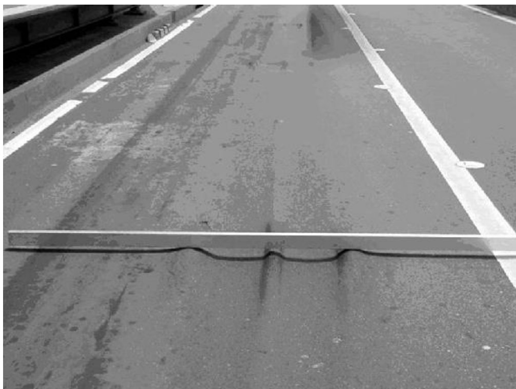
Figura N° 23: Falla tipo ahuellamiento
