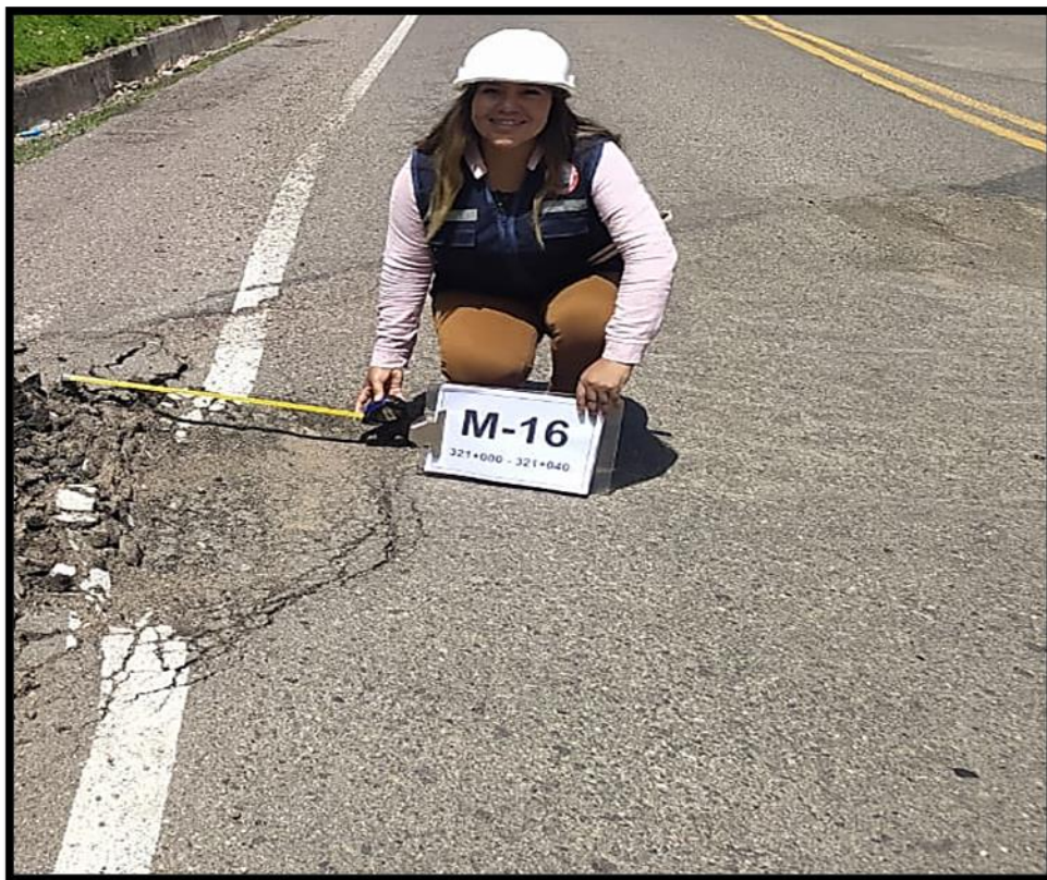
FOTO N°12: Falla tipo grietas parabólicas.
