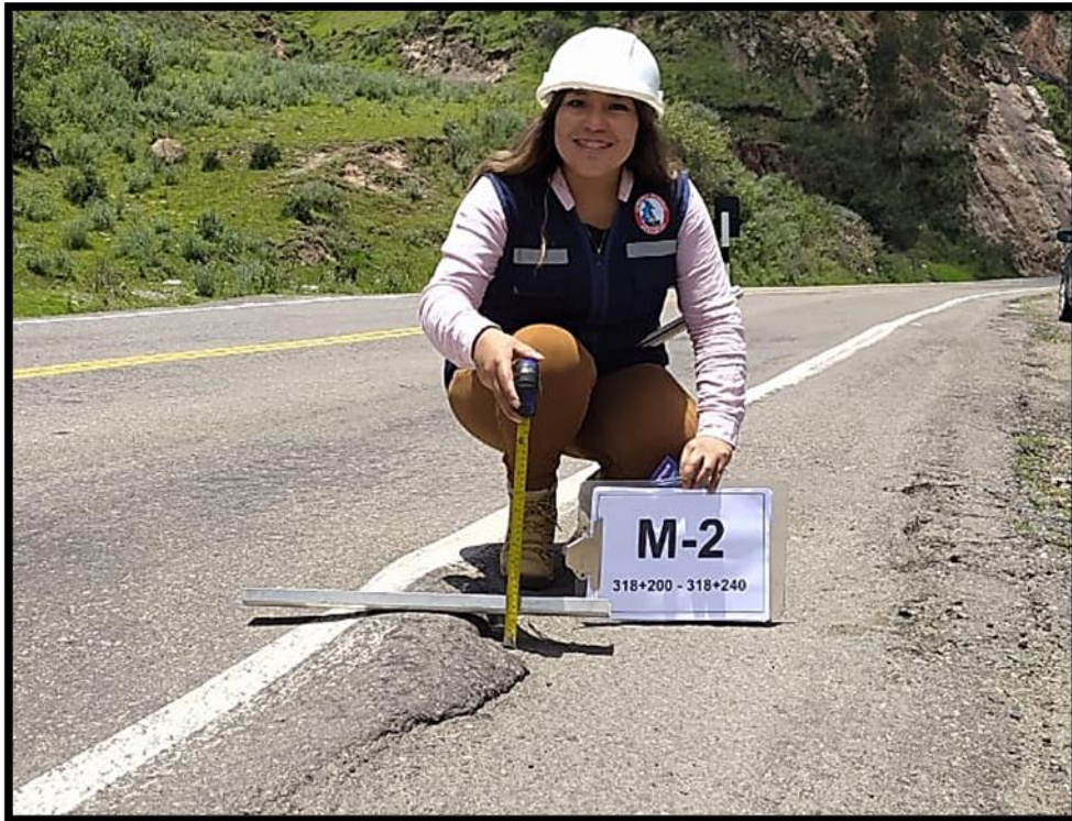
FOTO N°07: Falla tipo Abultamiento
