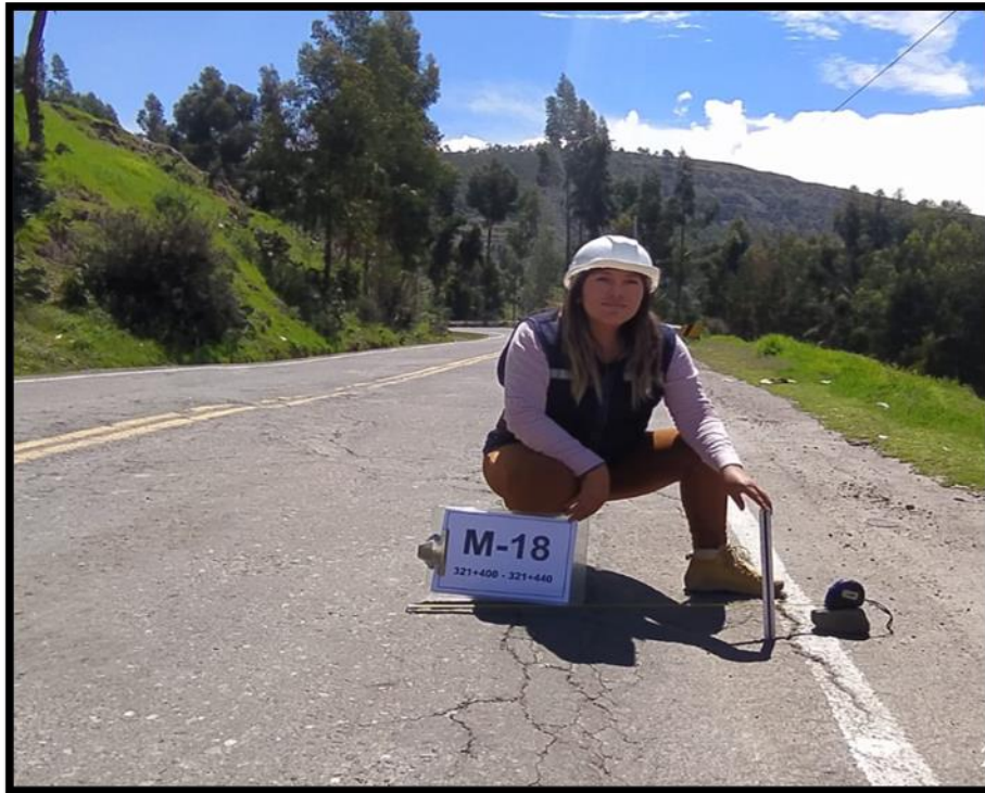
FOTO N°09: Falla tipo depresión
