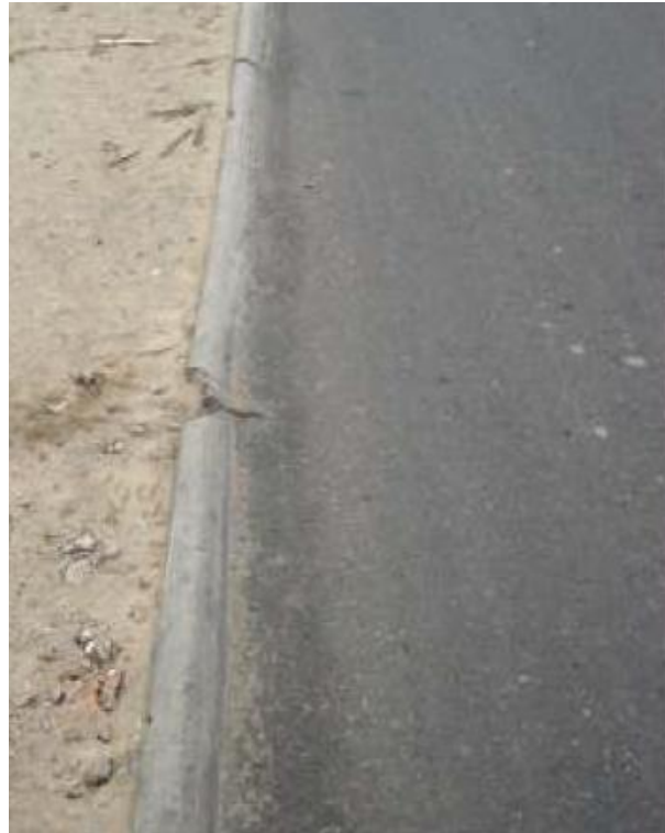
Figura N° 24: Falla tipo desplazamiento
