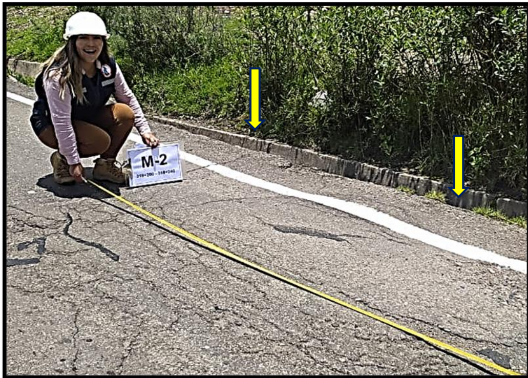
FOTO N°08: Falla tipo hundimientos
