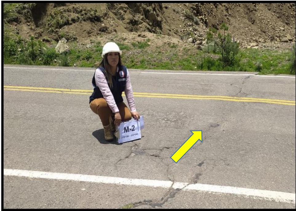
FOTO N°03: Tipo de falla transversal en la via Lbertadores.
