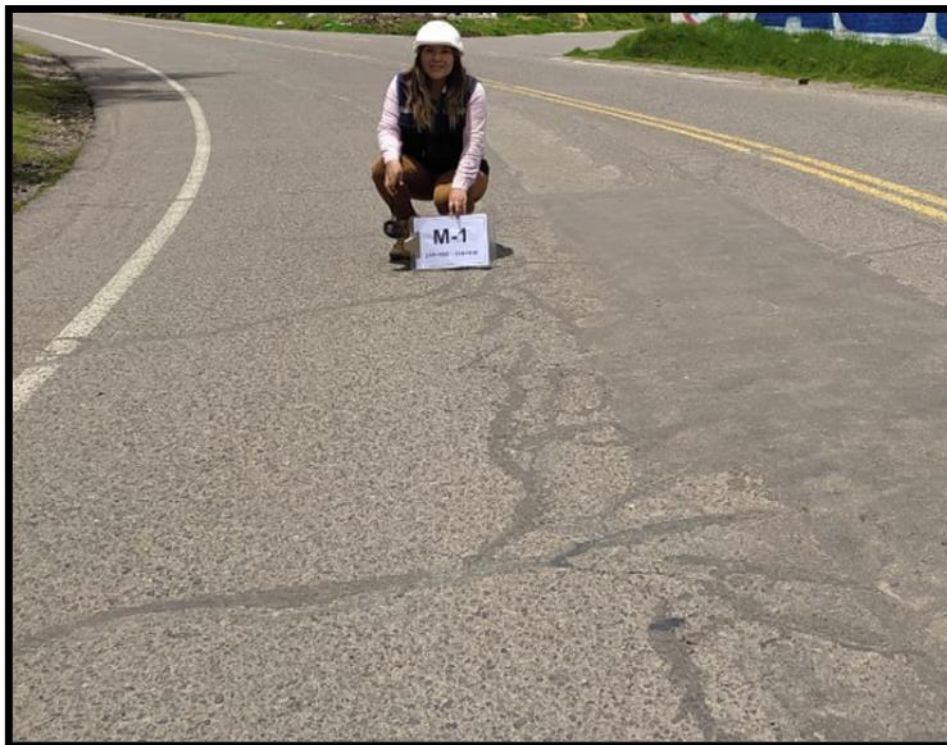
FOTO N°10: Falla tipo parches, en la vía Libertadores
