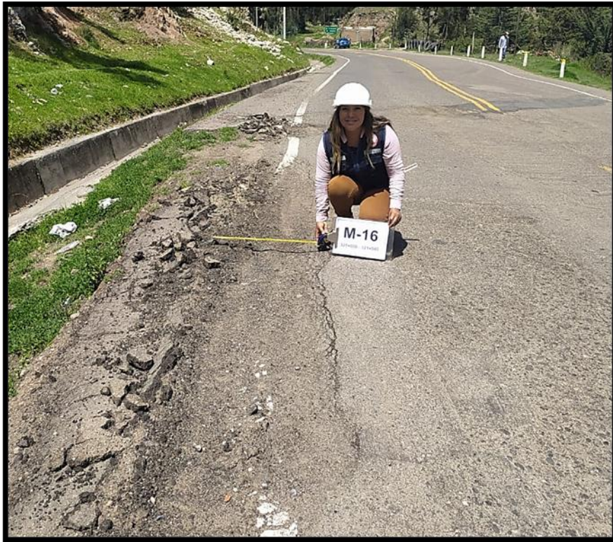
FOTO N°13: Falla tipo hinchamiento
