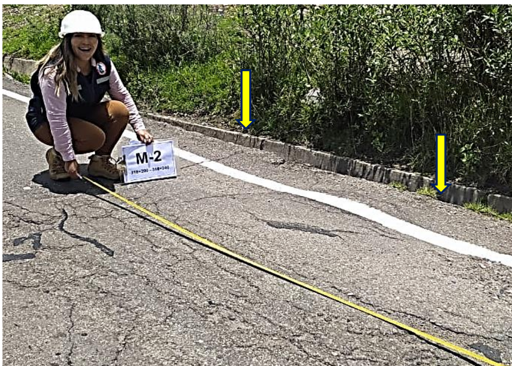
Figura N° 11 Falla tipo Abultamiento y hundimientos
