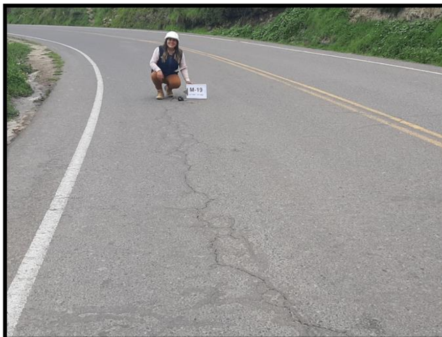
FOTO N°02: Tipo de falla longitudinal en la via Lbertadores.
