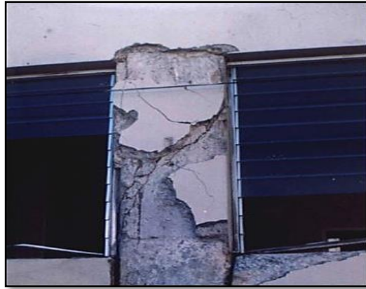
Figura. 03. Falla por Cortante
