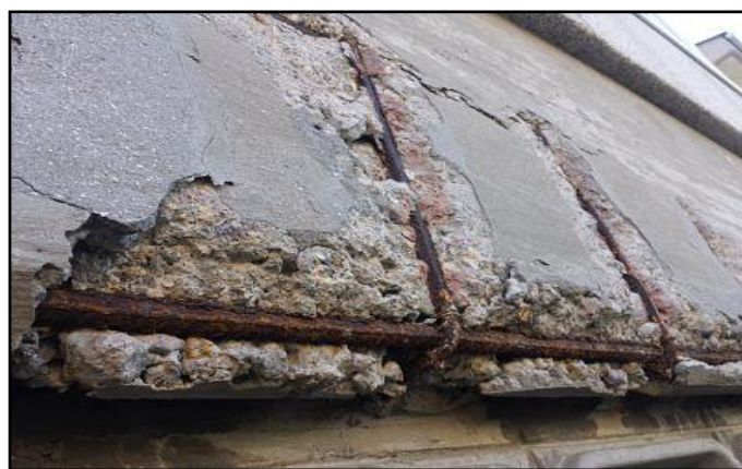
Figura. 08. Falla por Corrosión de armadura en vigas
