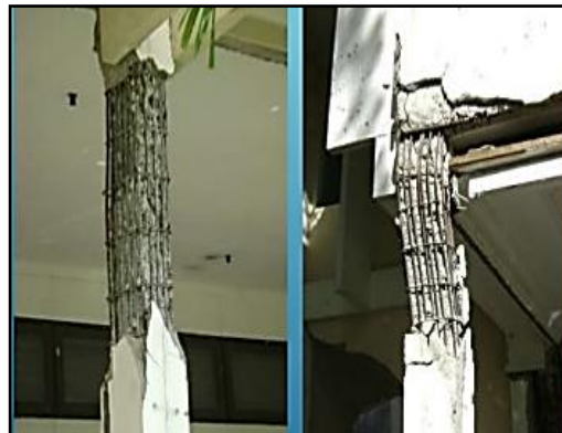
Figura. 04. Falla por la corrosión de la armadura
