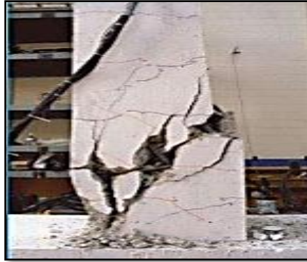
Figura. 01. Falla por Aplastamiento
