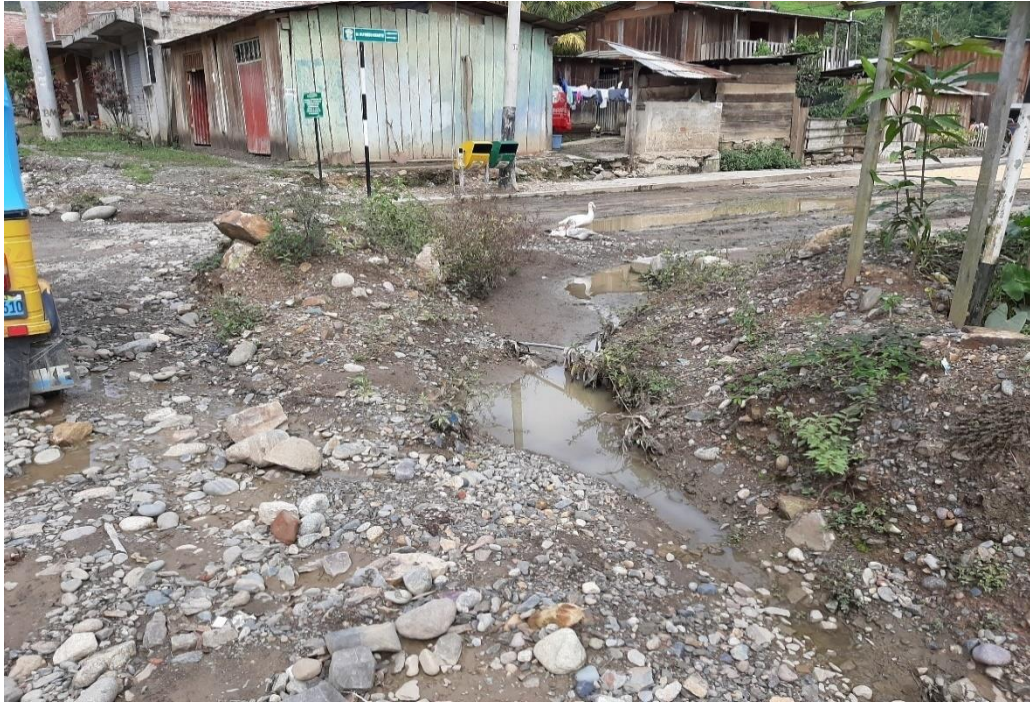
FIGURA 8: Se observa en la foto, que los jirones se convierten el charco a falta de un adecuado sistema de drenaje pluvial, que dificulta la transitabilidad y accesibilidad vehicular y peatonal, en tiempos de lluvia y son focos de propagación de sancudos.
