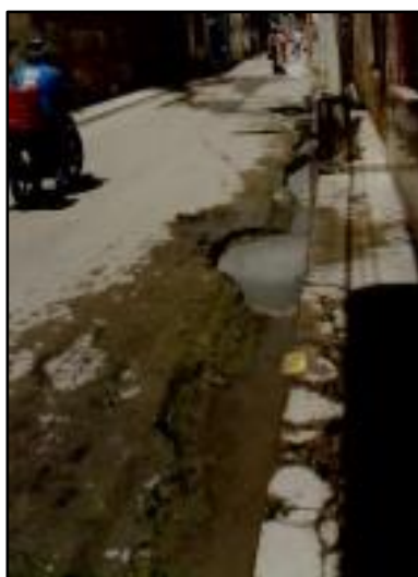
Ilustración 3 Problema de drenaje Campeche
