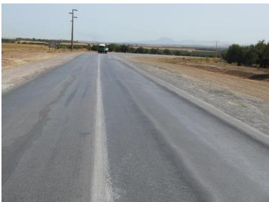
Figura 7. Falla por ahuellamiento en pavimentos flexibles.
