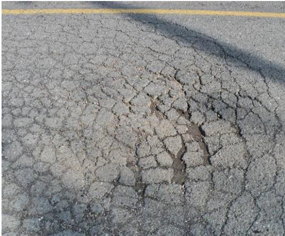
Figura 10. Fisuración por fatiga.
