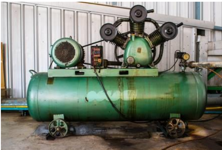
Figura N° 3: Compresor en mal estado
