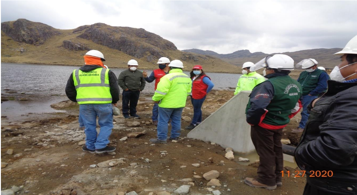
Figura 47. En vista se observa la recomendación y paralización de la obra en vista de los trabajos realizados sin la autorización por parte de UE y MINISTERIO DE VIVIENDA, CONSTRUCCIÓN Y SANEAMIENTO.
