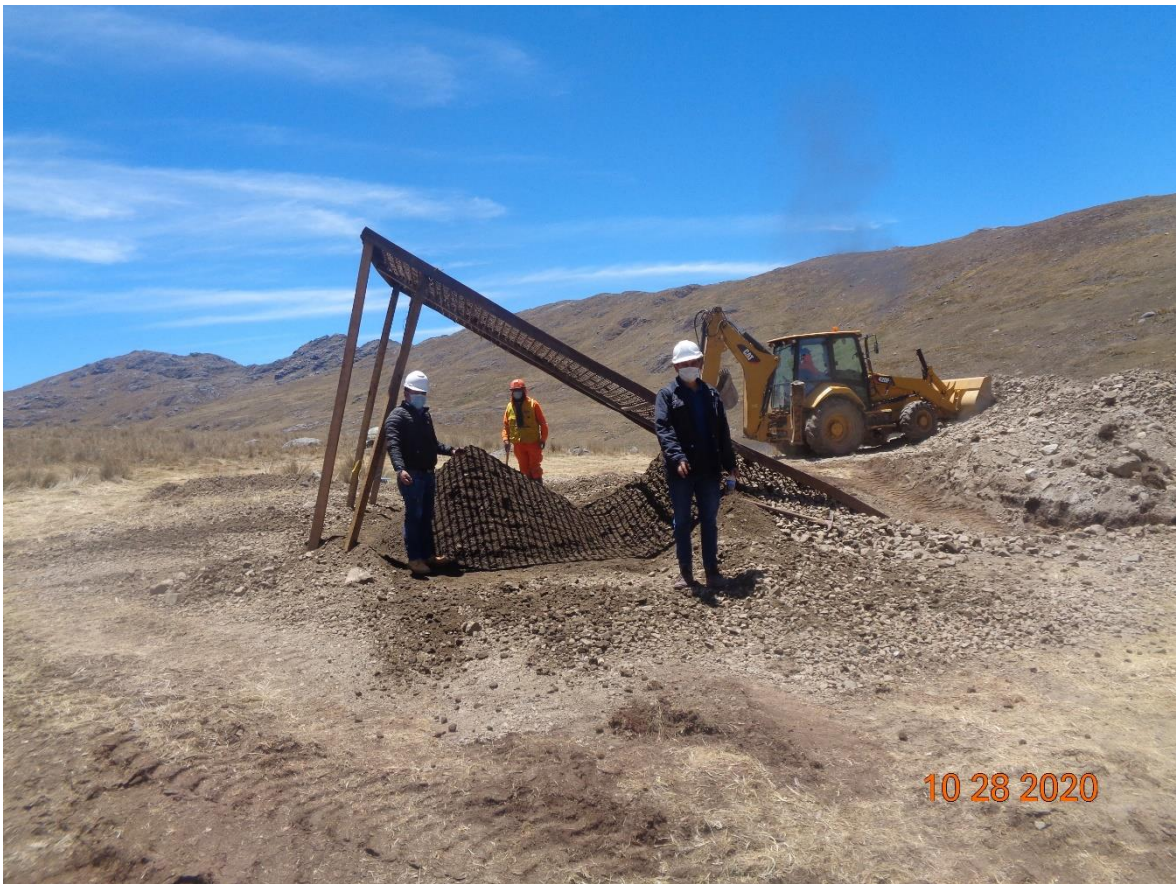
Figura 50. En vista se observa la Verificación de los materiales de calidad de arena y zarandeo correspondiente como lo indicado en el expediente técnico.
