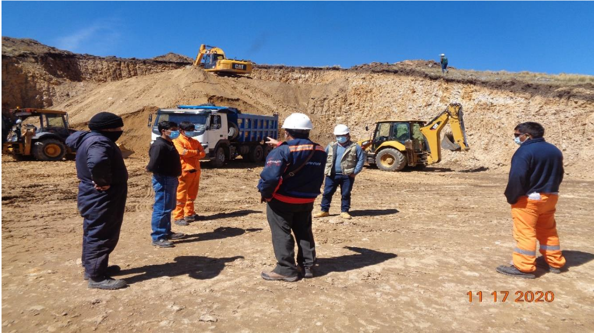
Figura 39. En vista se observa el material zarandeado, se recomienda usar un tamaño máximo de hasta 4" y capas de hasta 30cm de alto.
