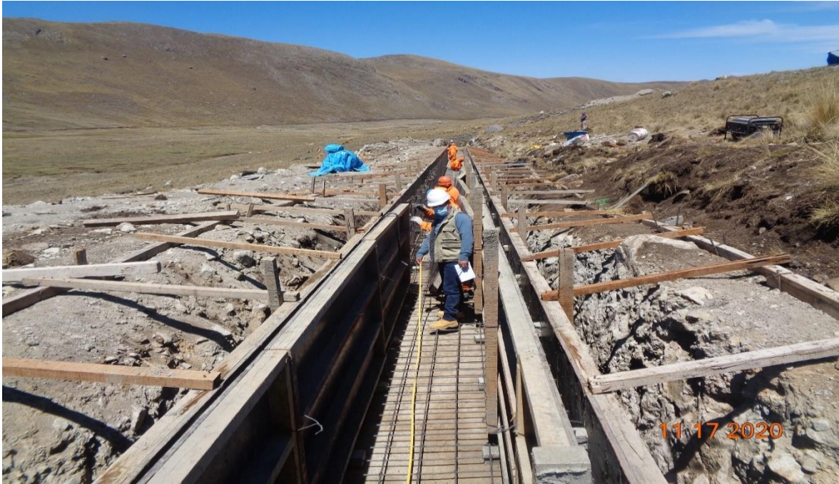
Figura 53. En vista se observa la verificación del proceso constructivo del aliviadero de 221.67 metros lineales.
