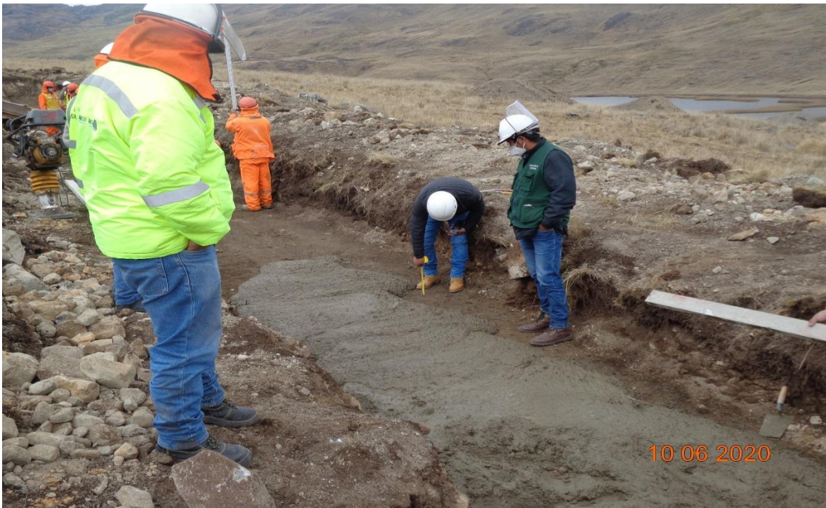
Figura 52. En vista se observa la verificación y coordinaciones con el residente de obra, según lo indicado en el expediente técnico del aliviadero.
