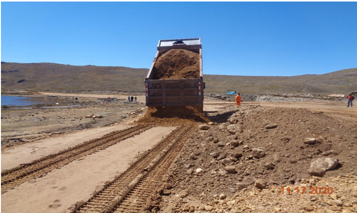
Figura 40. En vista de observa material de préstamo de 4" y compactación por capas de hasta 30cm de alto.
