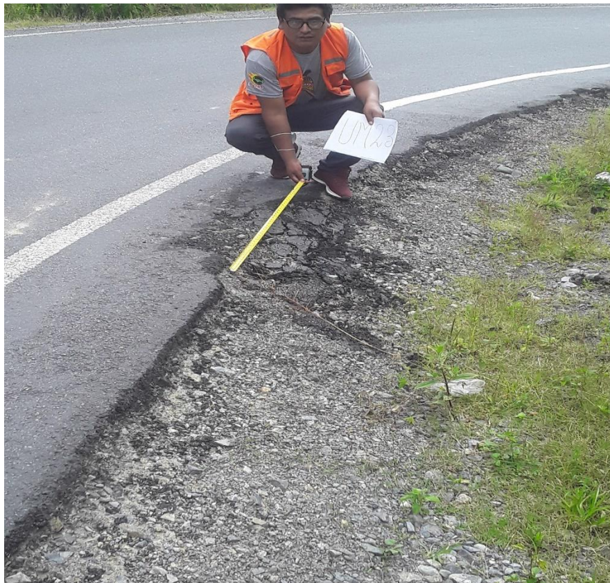
se ubica falla de tipo fisura de borde con severidad alto
