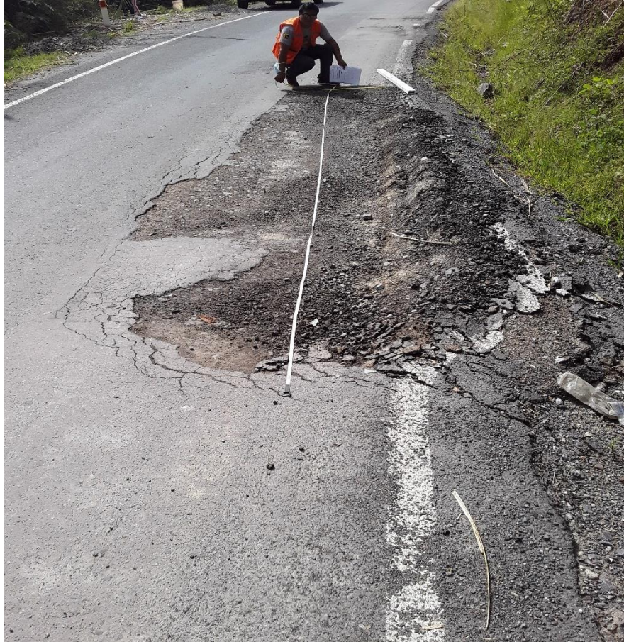
se ubica falla de tipo abultamiento de severidad alta
