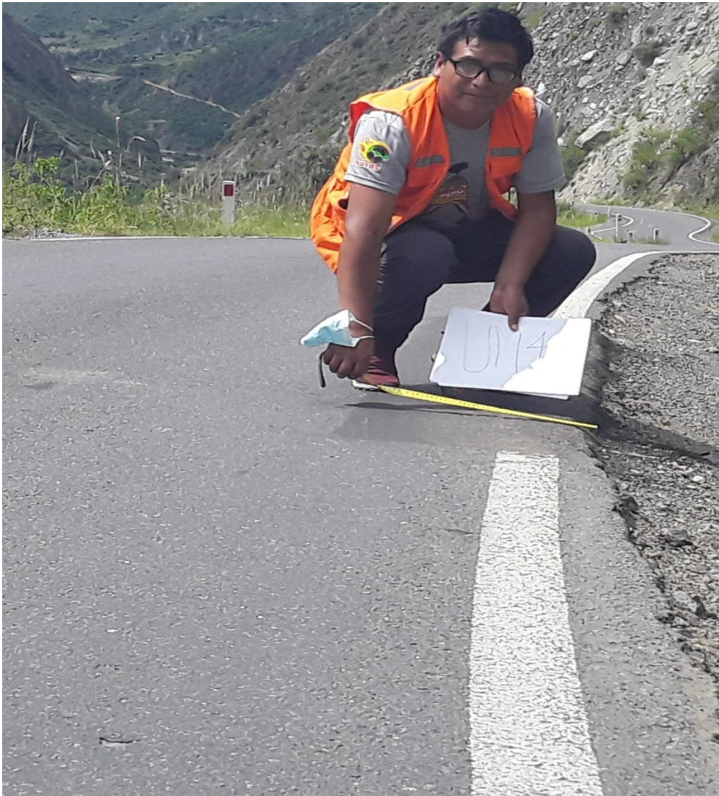
se ubica falla de tipo parcheo de nivel de severidad bajo
