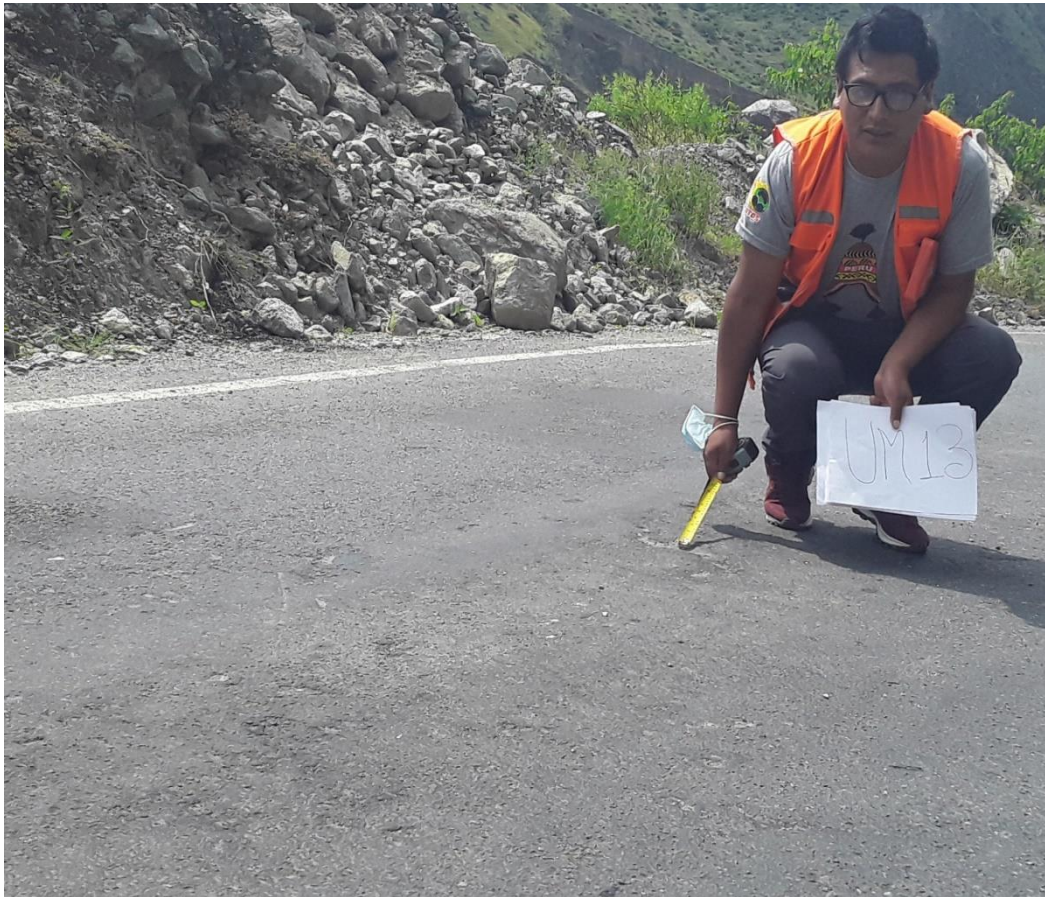
se ubica falla de tipo exudación con nivel de severidad medio
