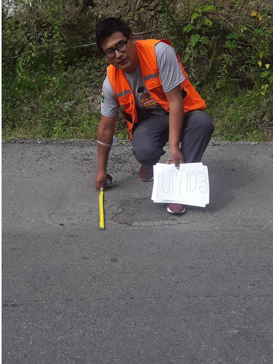
se ubica falla de tipo piel de cocodrilo de severidad medio
