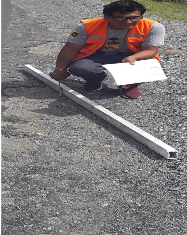
se ubica falla de tipo exudación con nivel de severidad medio
