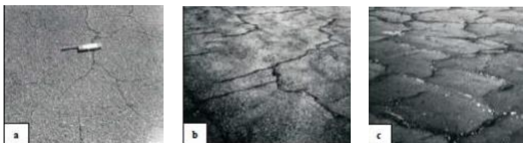
Figura 10: Fisuras en bloques de niveles de gravedad bajo(a), medio(b) y alto(c).
