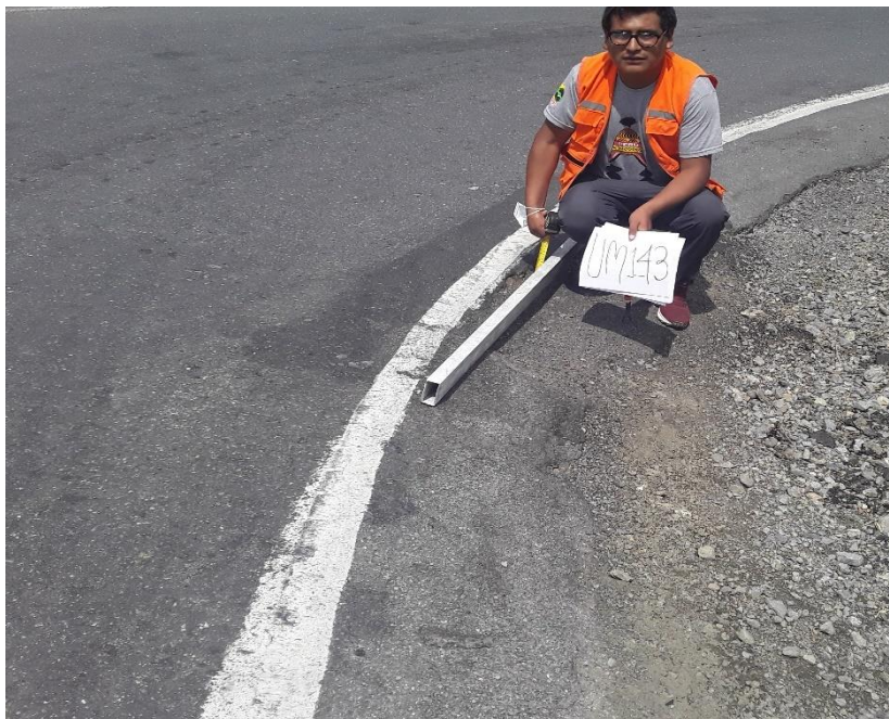
se ubica falla de tipo corrugación en borde de vía de severidad alto
