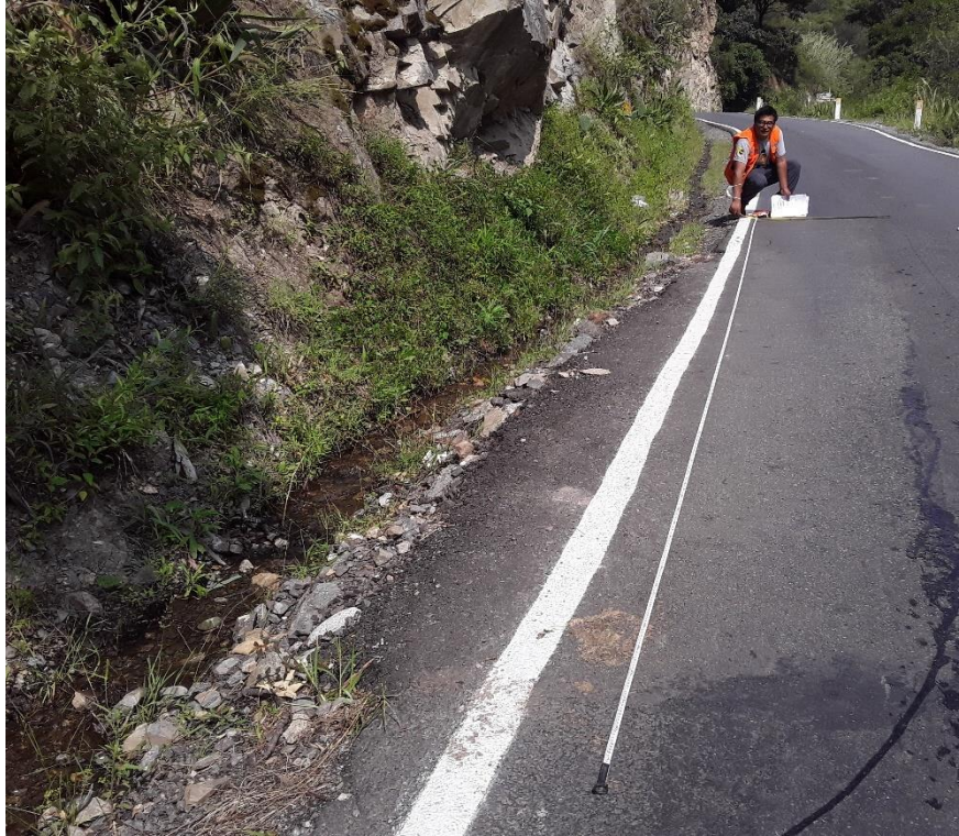
se ubica falla de tipo parches con nivel de severidad bajo
