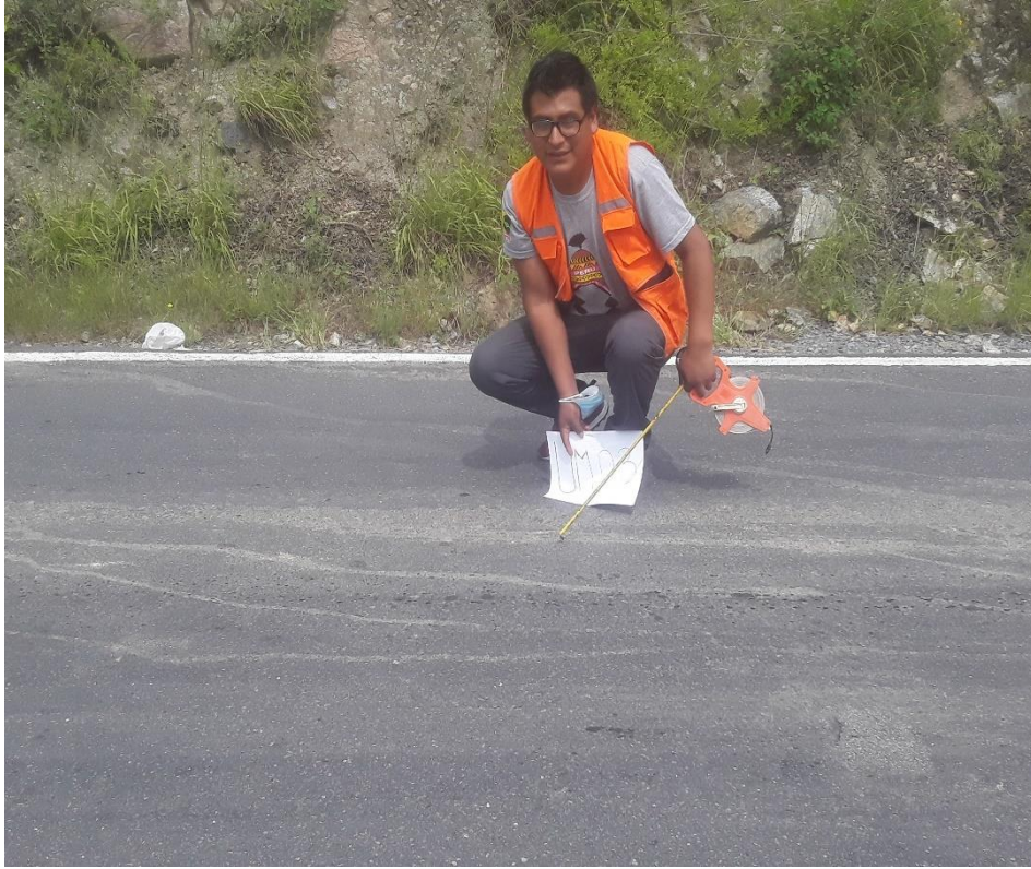
se ubica falla piel de cocodrilo con severidad baja
