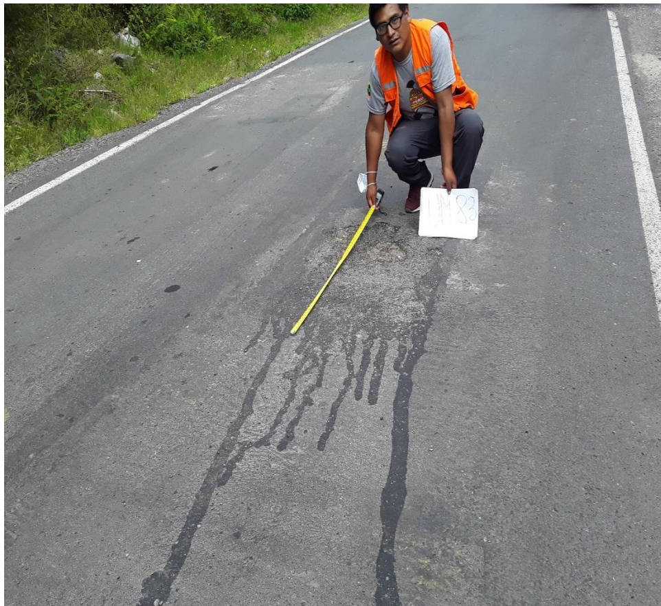
se ubica falla de tipo exudación con severidad medio
