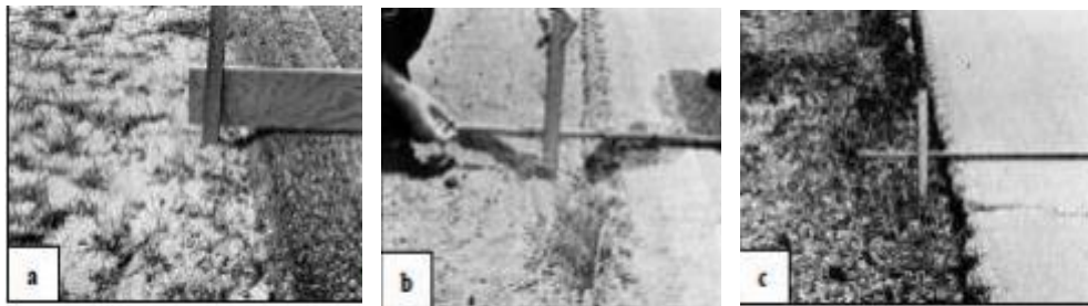
Figura 15: Desnivel carril-berma de nivel de gravedad bajo(a), medio(b) y alto(c). Fuente: ASTM D6433-07
