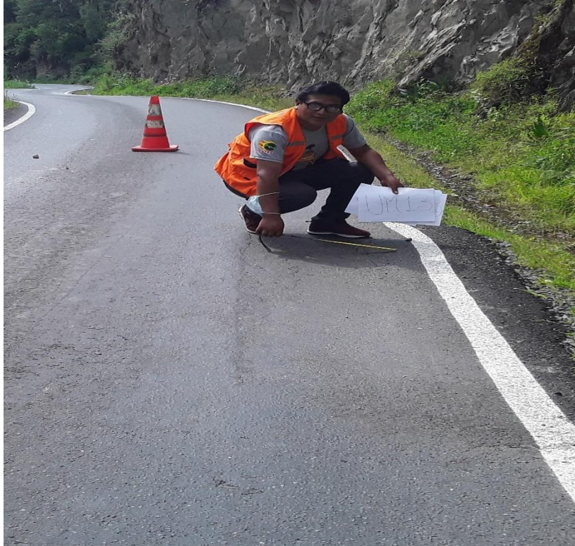
se ubica tipo de falla parcheo corrugado con nivel de severidad bajo
