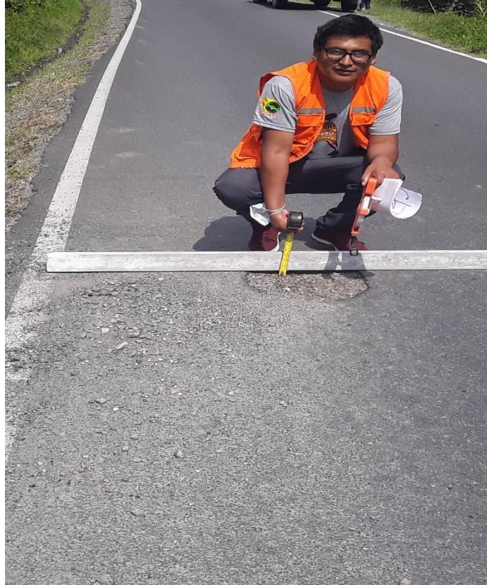
se ubica falla de tipo bache con nivel de severidad medio
