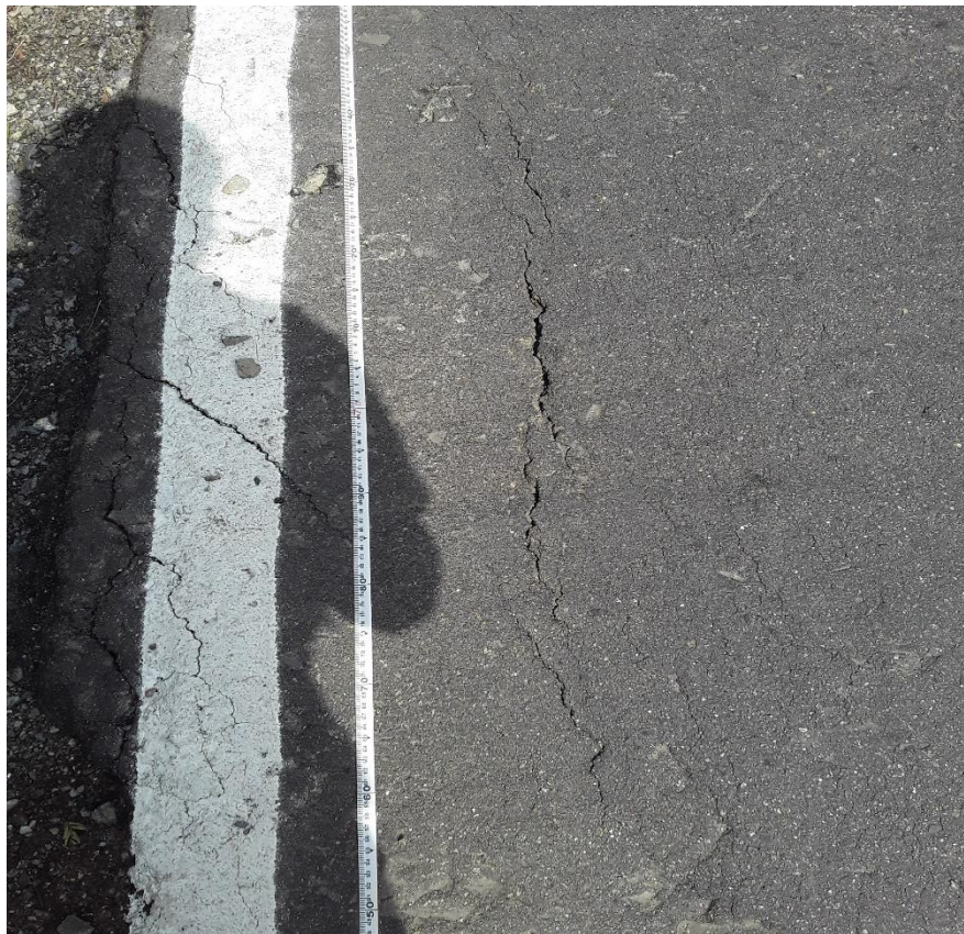
se ubica falla de tipo fisura de borde con severidad medio
