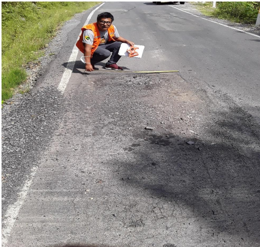
se ubica falla de tipo abultamiento de severidad alta
