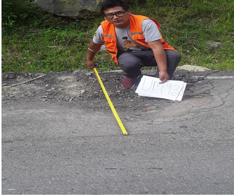
se ubica falla de tipo abultamiento de severidad alta
