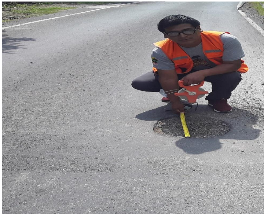
se ubica falla de tipo bache con nivel de severidad medio
