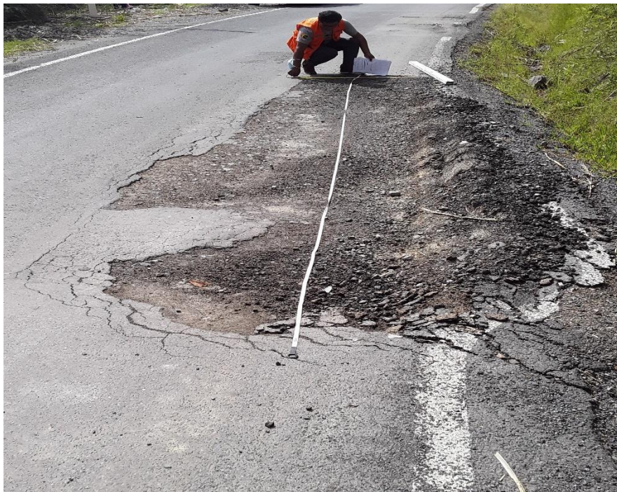
se ubica falla de tipo abultamiento de severidad alta
