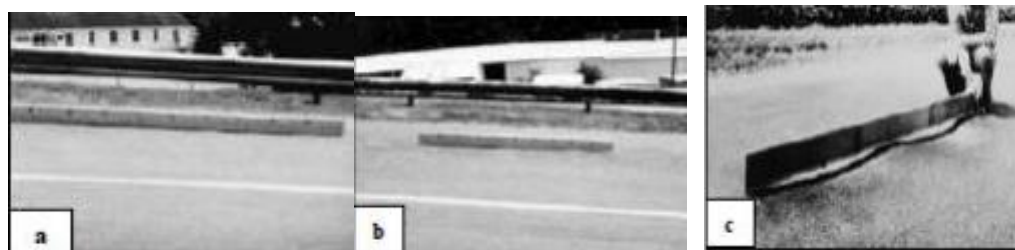
Figura 12: Corrugación de nivel de gravedad bajo (a), medio (b) y alto (c).
