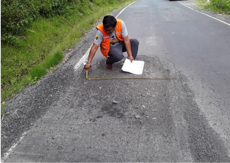
se ubica falla de tipo abultamiento de severidad alta
