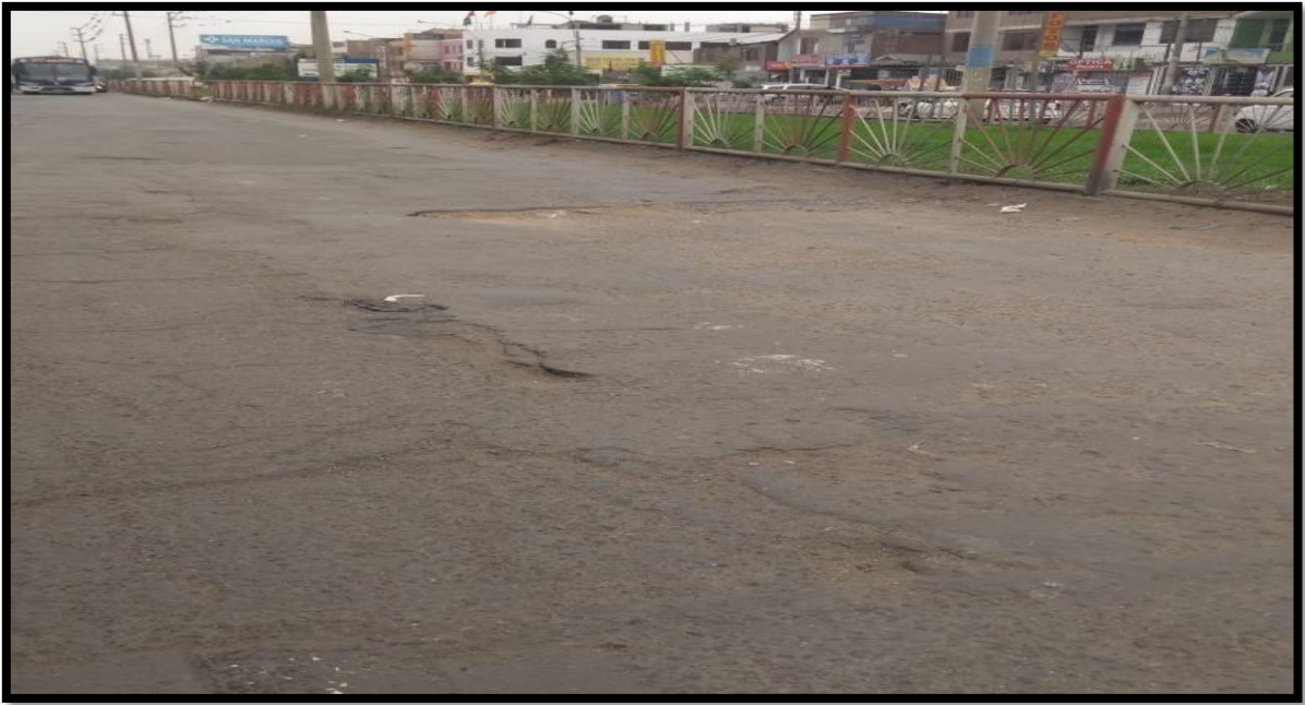
Figura 9. Grieta transversales y longitudinales
