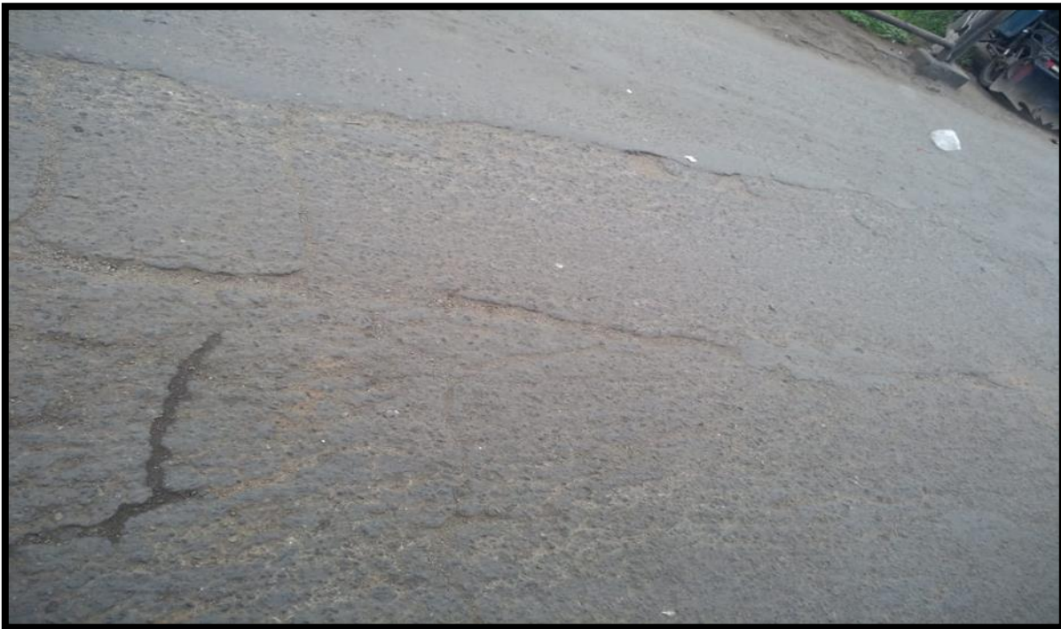
Figura 10. Perdida de áridos
