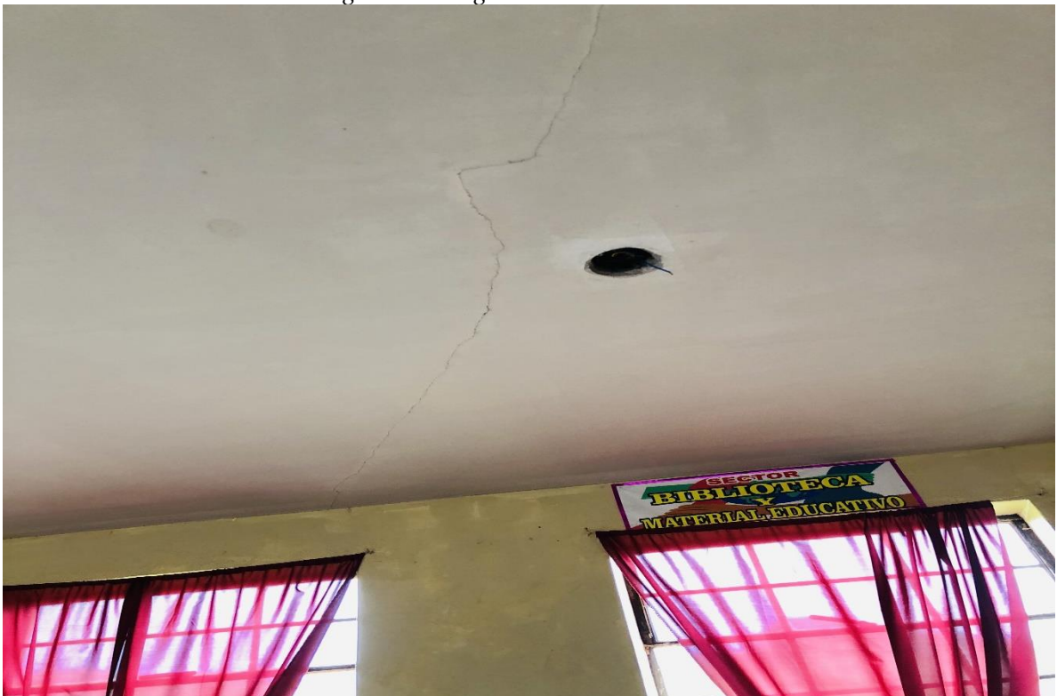
Figura 16: Agrietamiento de techos
