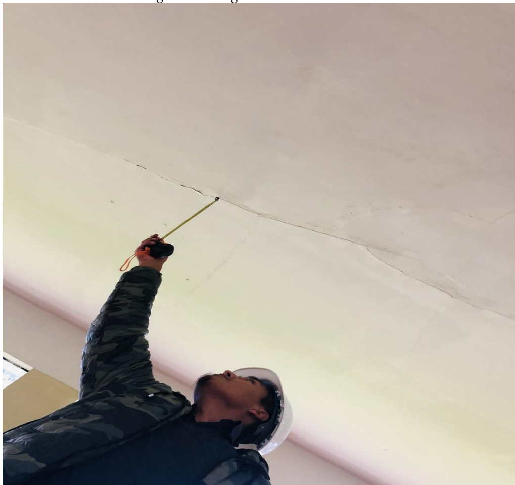
Figura 21: Agrietamiento en techos
