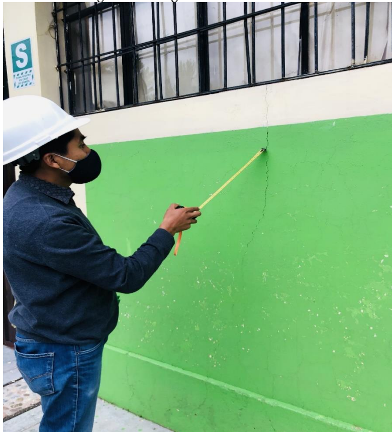
Figura 19: Agrietamiento en muros
