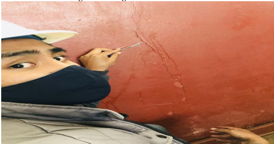
Figura 27: Agrietamiento en muros
