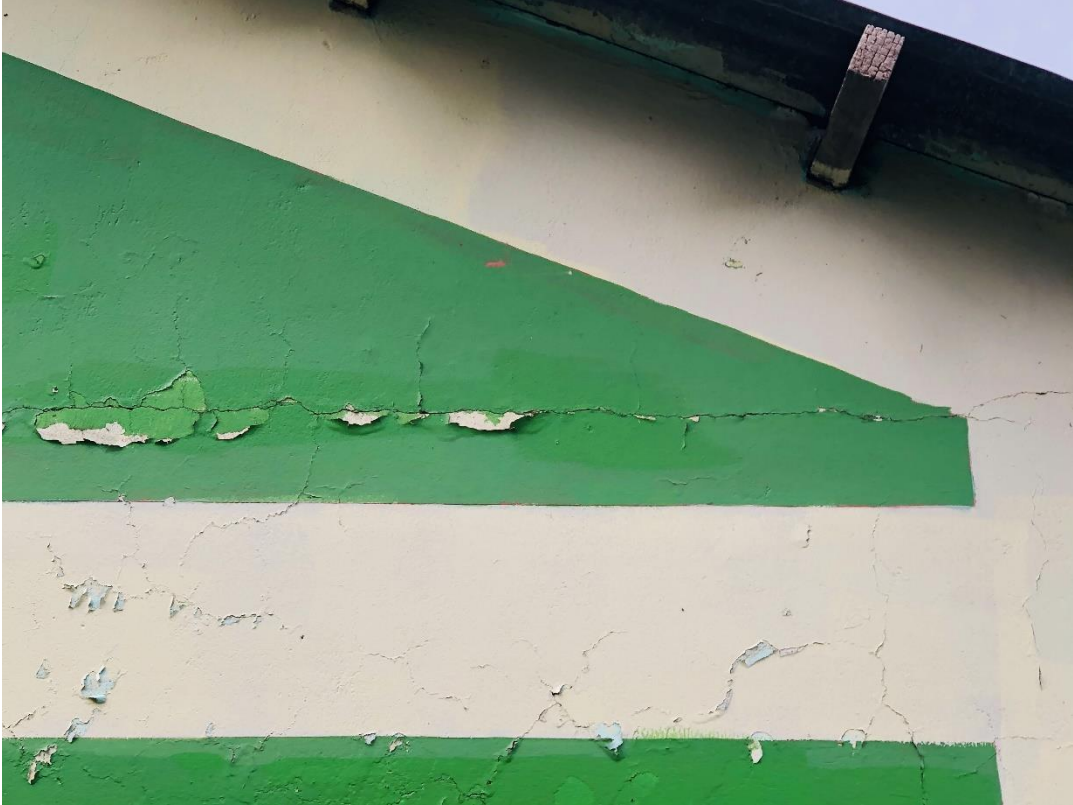
Figura 14: Agrietamiento en muro
