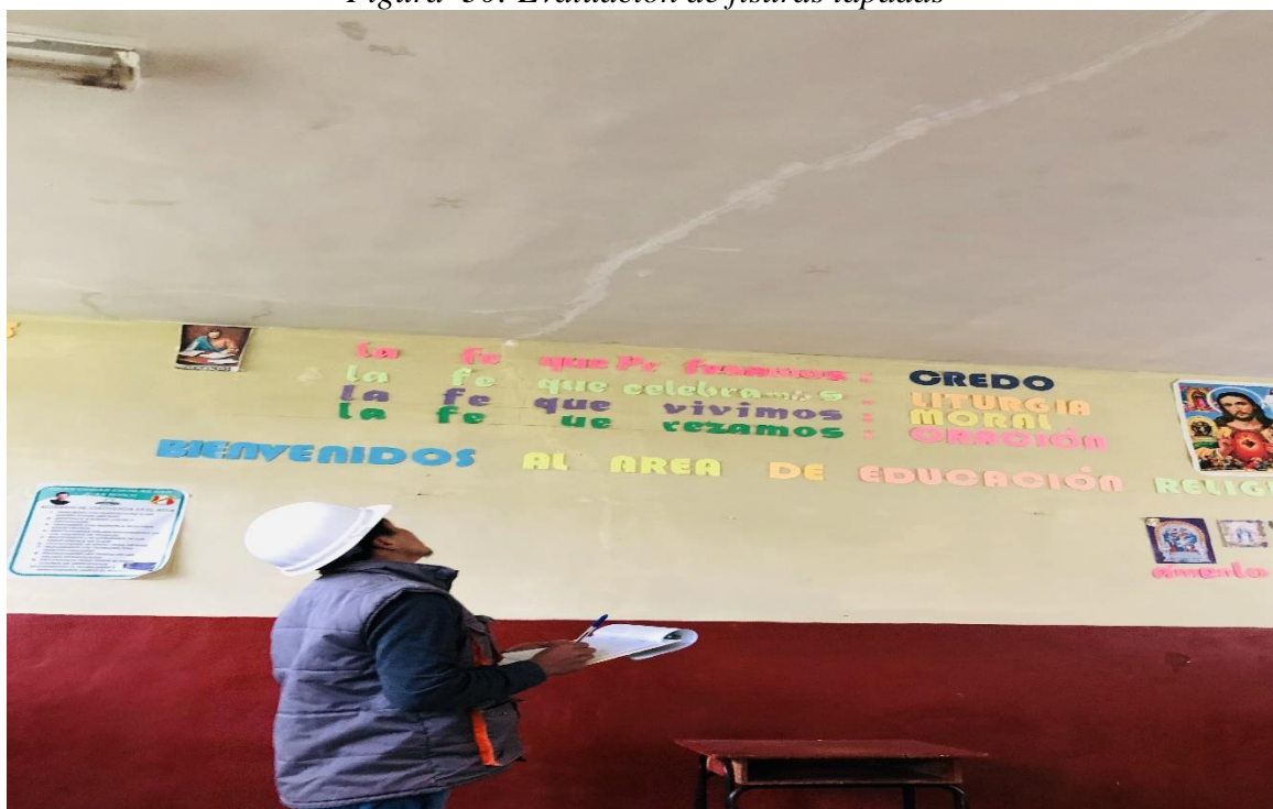
Figura 30: Evaluación de fisuras tapadas
