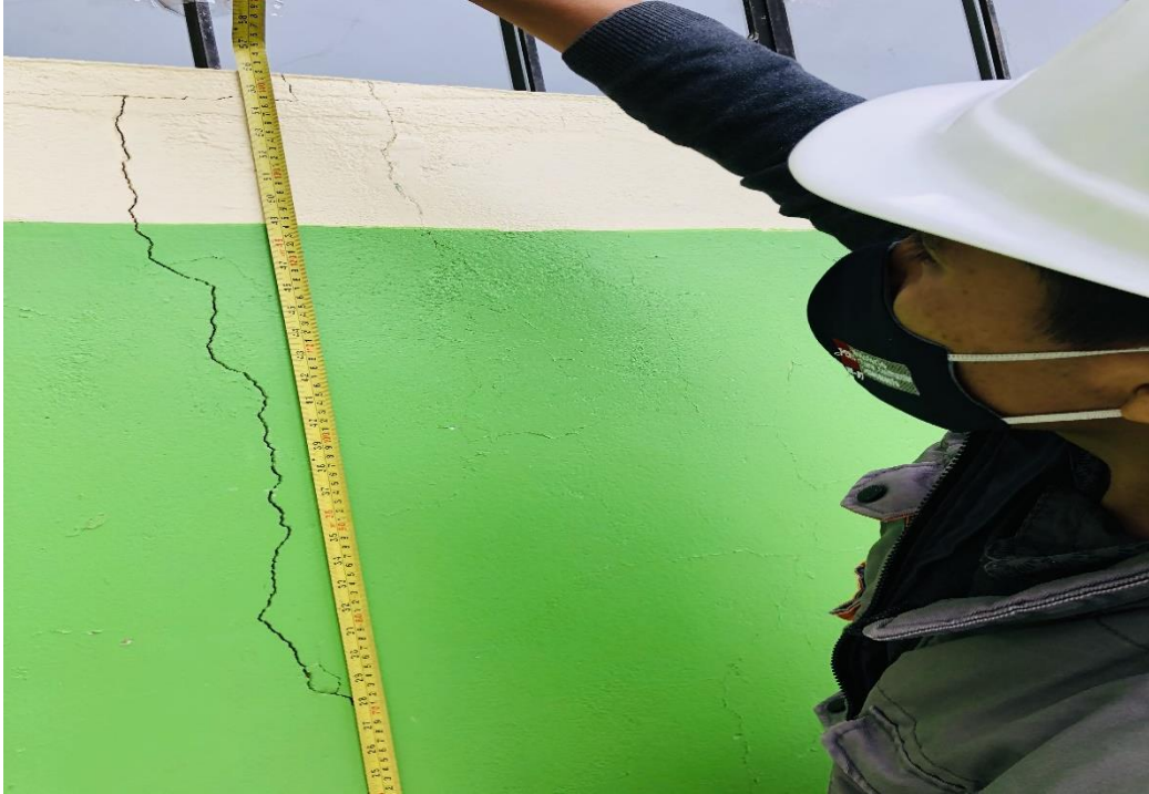
Figura 22: Agrietamientos en muros
