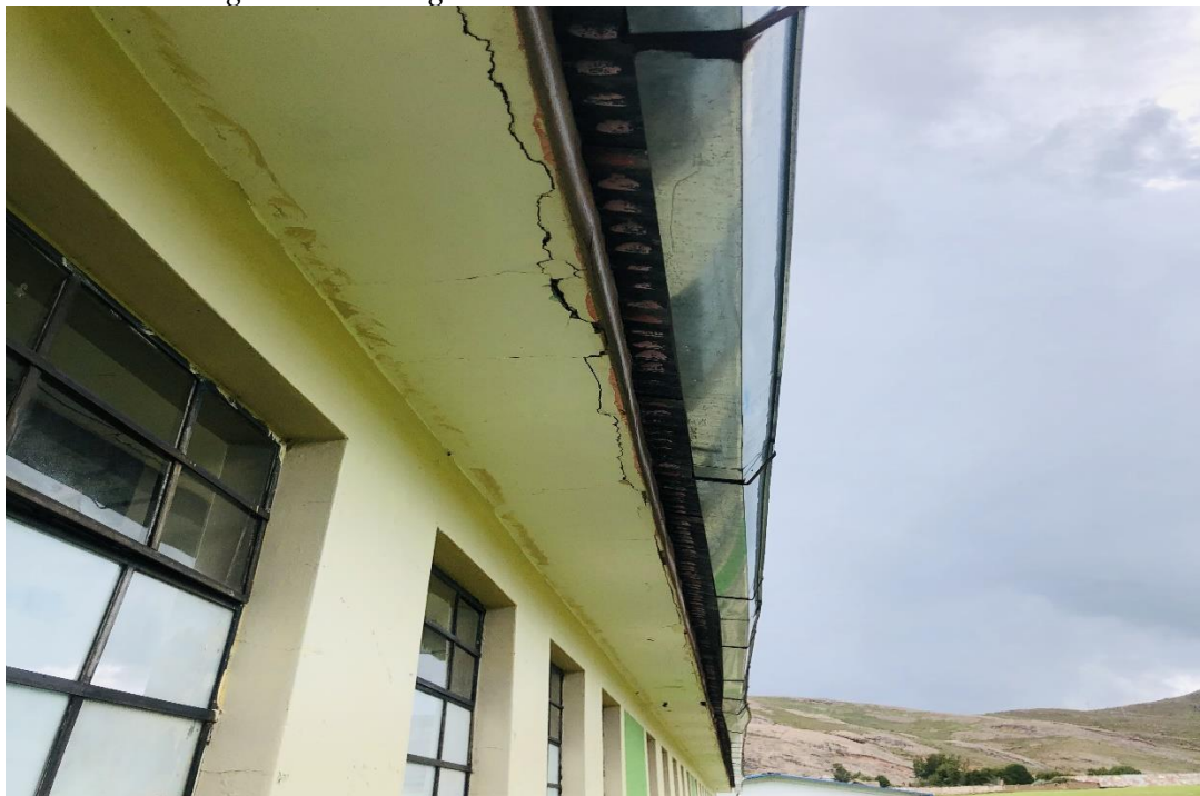
Figura 13: Los gabletes de los muros con debilitamiento
