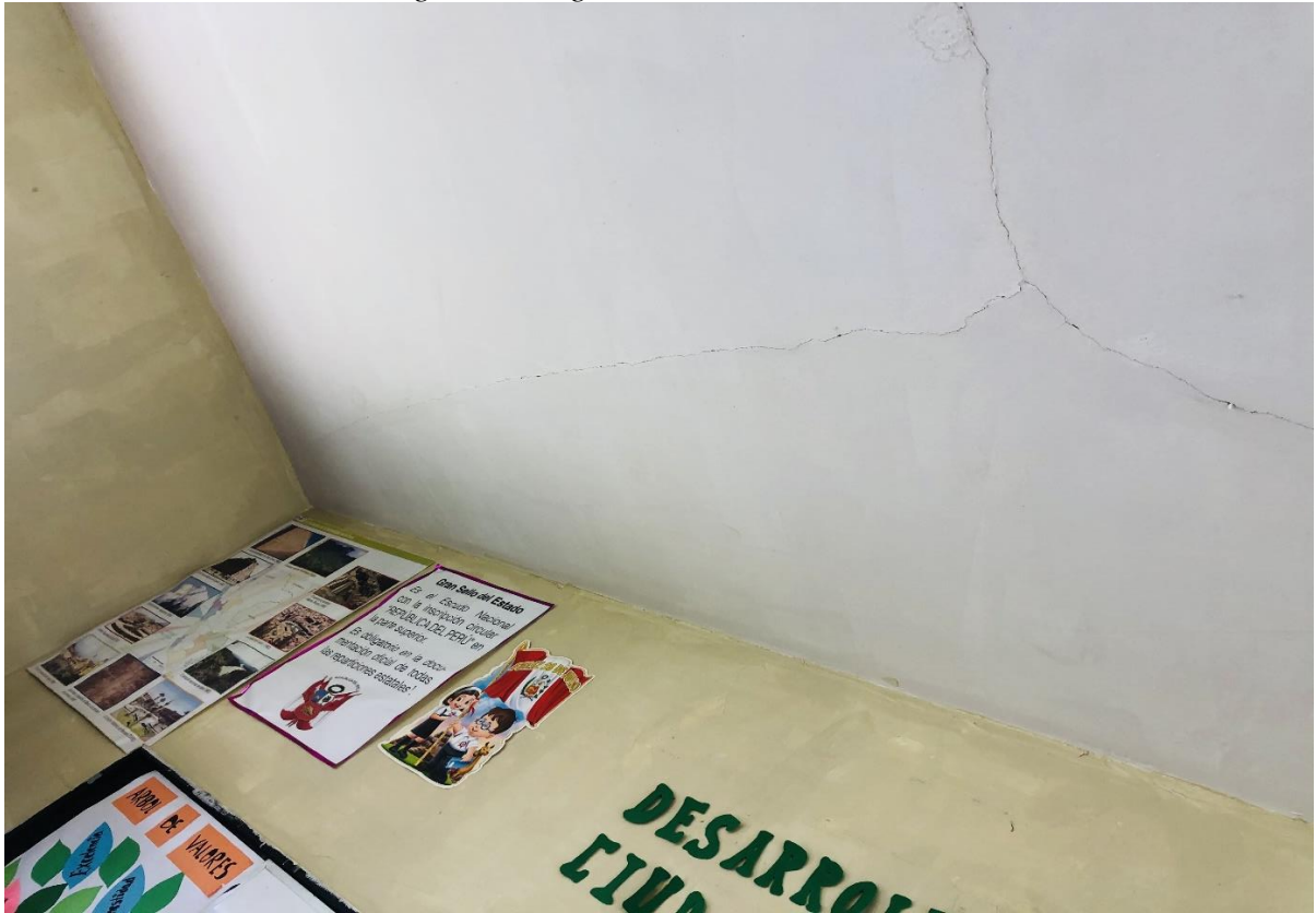
Figura 12: agrietamientos en techos
