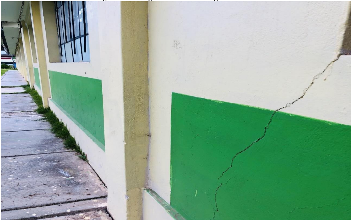
Figura 25: Agrietamiento diagonal en muro
