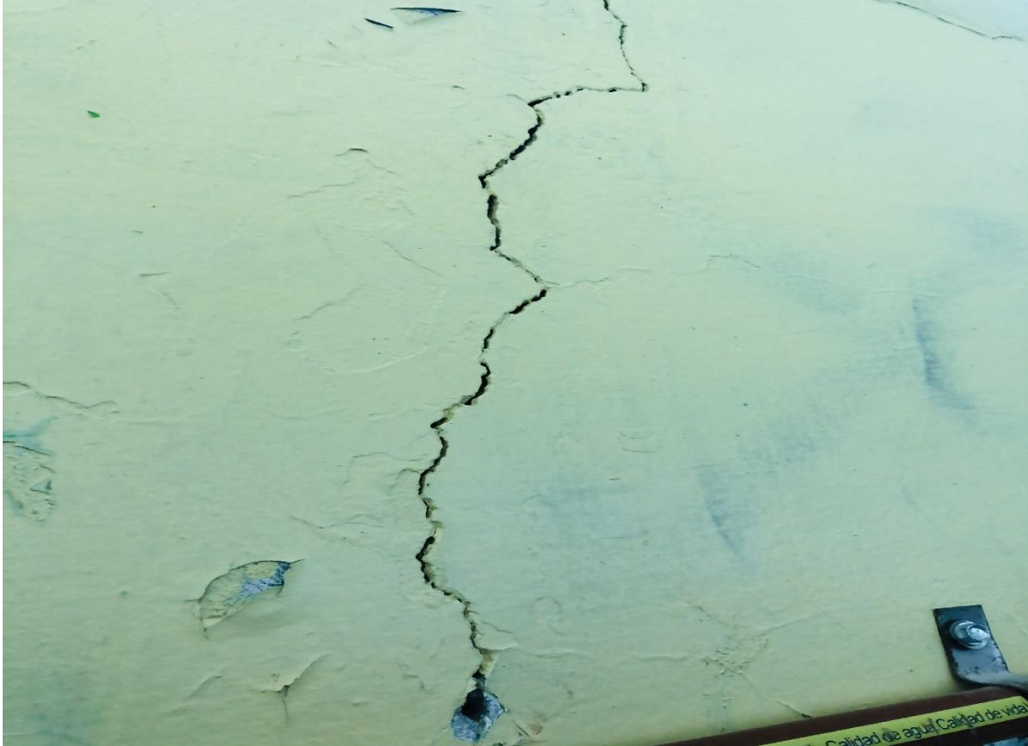
Figura 17: Agrietamiento en muros
