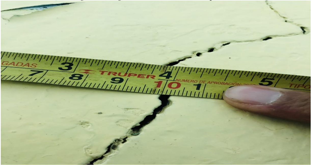
Figura 15: Agrietamientos en muros Bloque B
