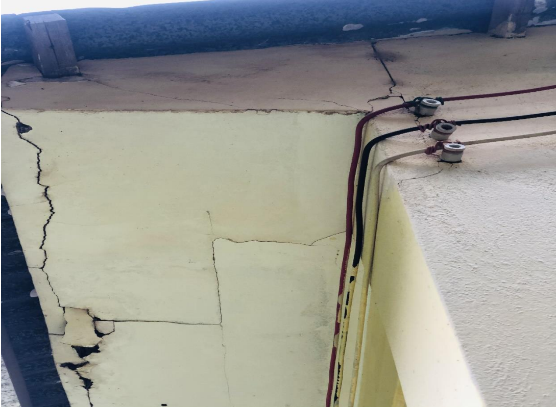
Figura 24: Gabletes de paredes en deterioro último
