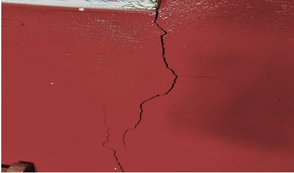
Figura 28: Agrietamiento en muros
