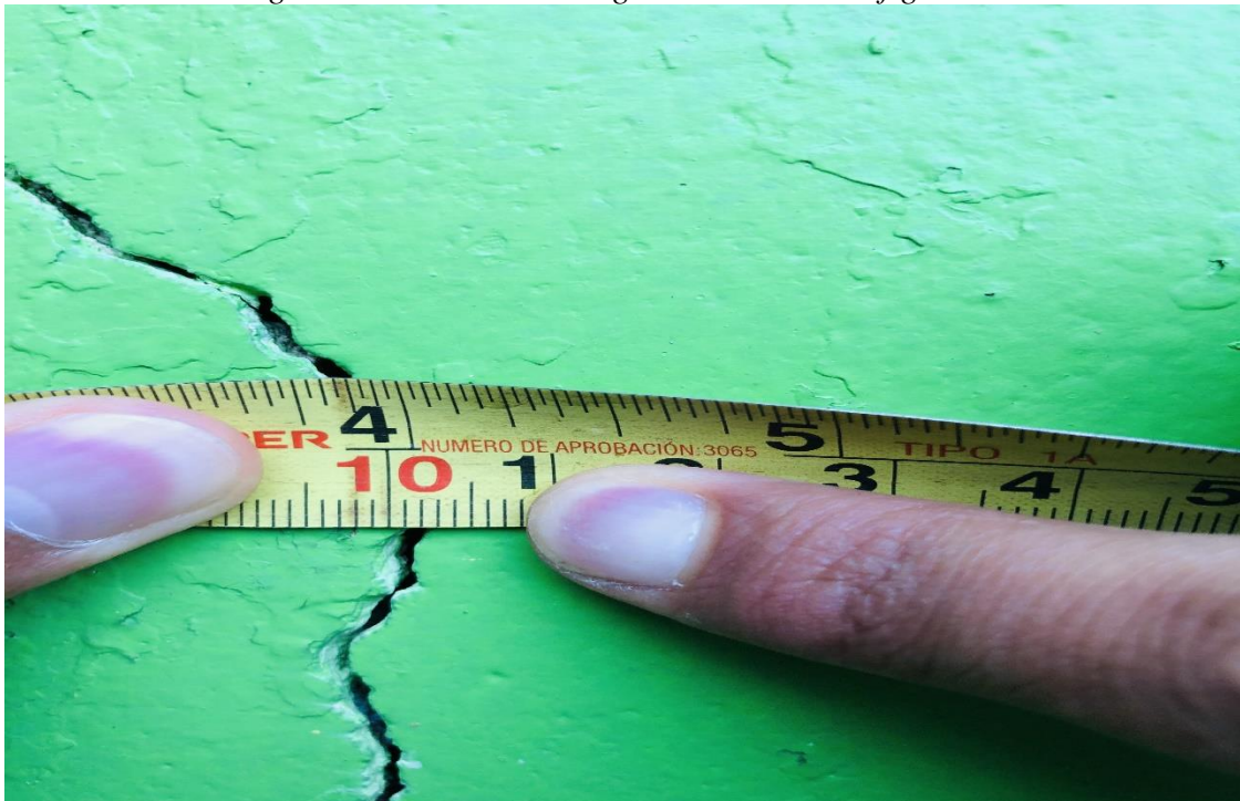
Figura 23: Medición de agrietamiento de la figura 22
