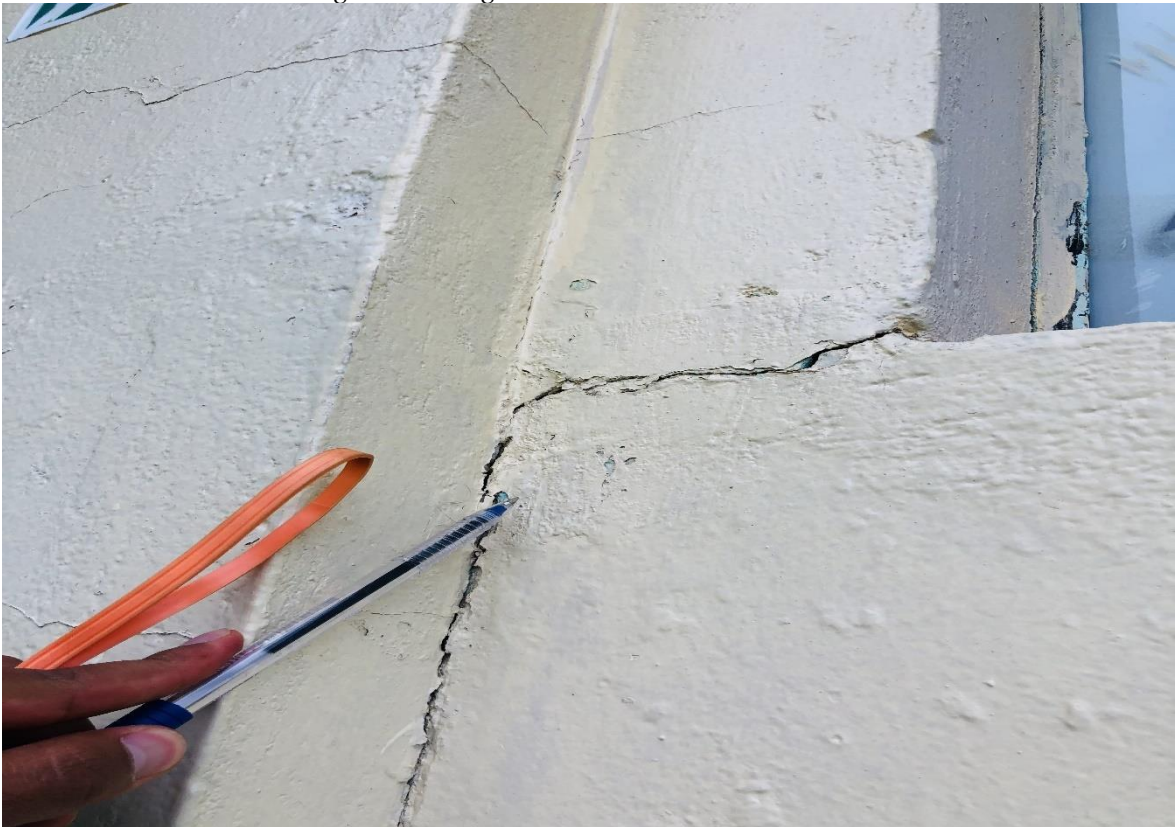
Figura 29: Agrietamiento en muros - vanos
