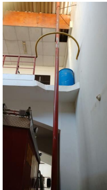
Ilustración N° 12 Fotografía: Tubo de deslizamiento Elaboración: Propia
