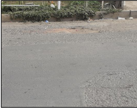
Figura 2. Baches en la Carpeta Asfáltica de la Avenida México.
