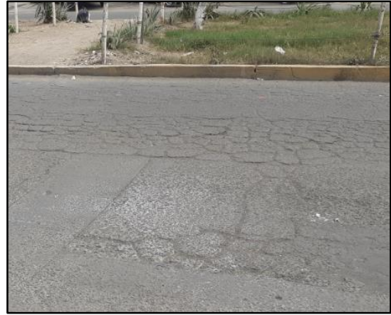
Figura 3. Grietas en la Carpeta Asfáltica de la Avenida México
