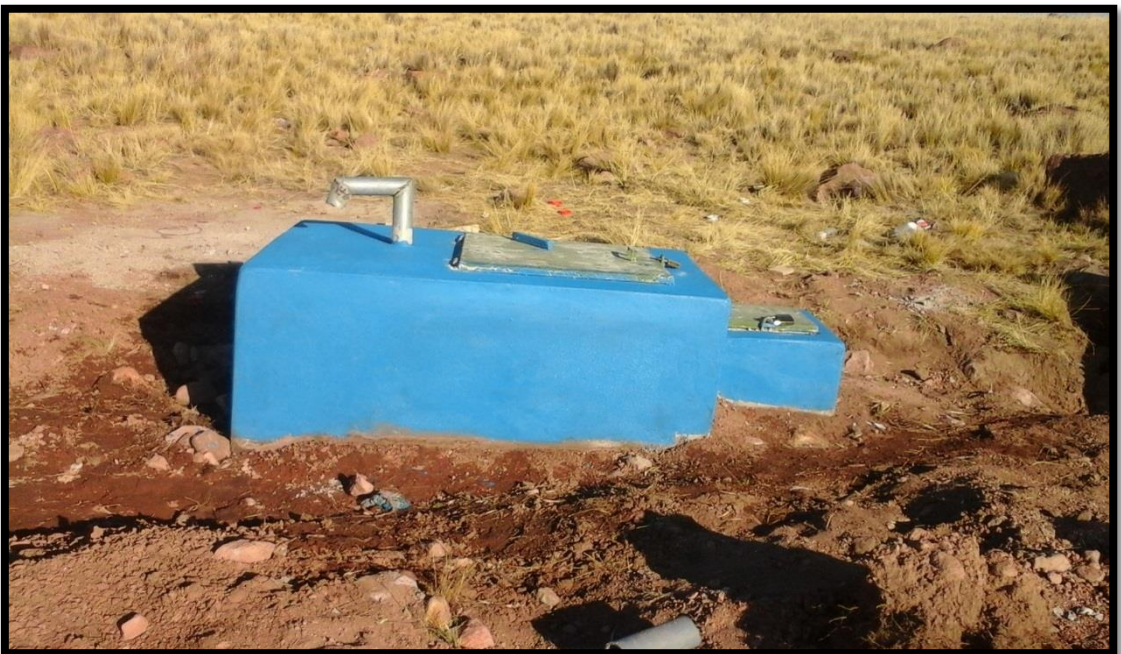
Fotografía 4 cámara rompe presión
