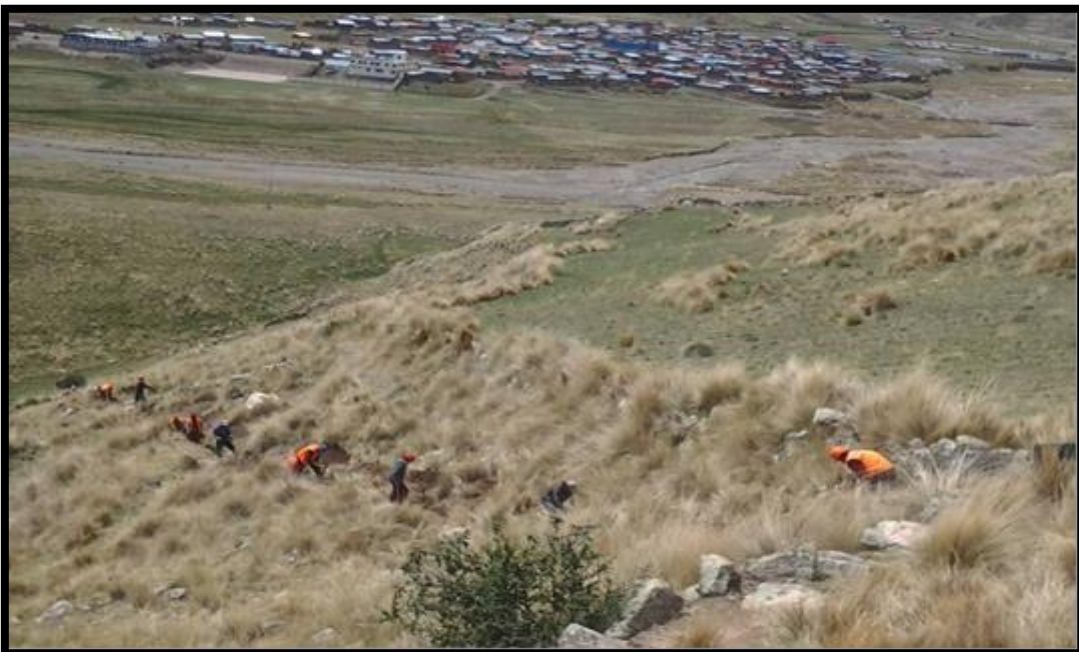
Fotografía 8 líneas de aducción
