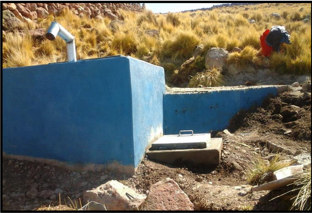
Fotografía 1 captación del sistema de agua potable
