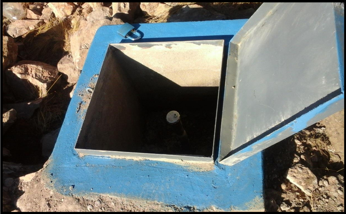
Fotografía 5 válvulas de aire automático
