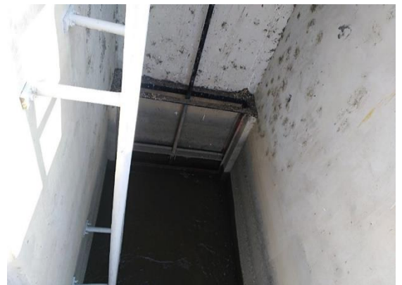
Figura 23: Compuerta de ingreso del caudal de agua
