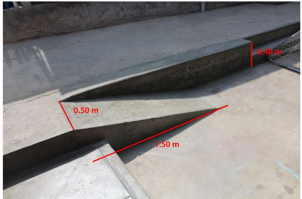
Figura 4. Rampa para discapacitado existente.
