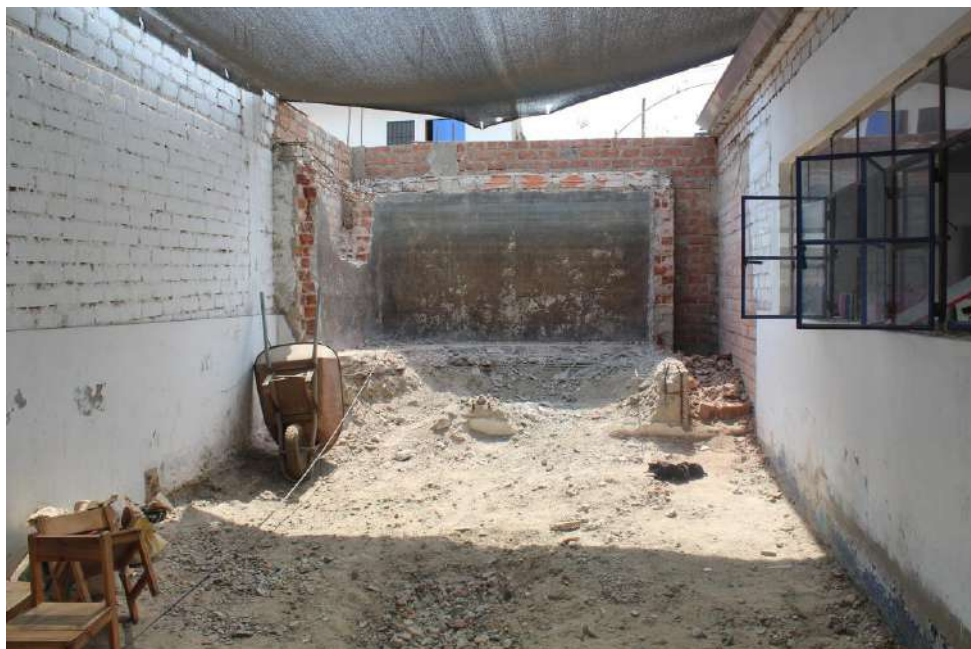
Figura 5. Serias condiciones de deterioro dentro de la infraestructura educativa.
