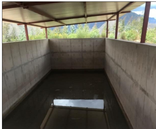
Figura 8. Pozo de lixiviados
