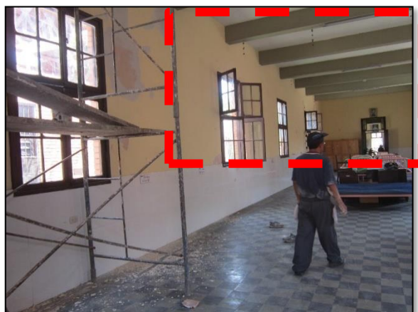
Figura 10: Se observa mediante la fotografía, el deterioro estructural de paredes y techo.
