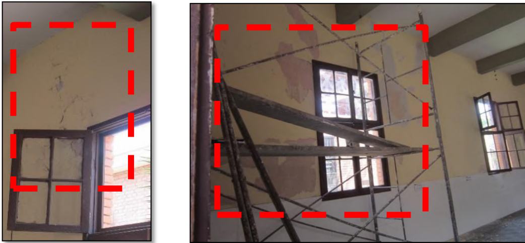
Figura 9: Se puede observar mediante la fotografía, el deterioro estructural.
