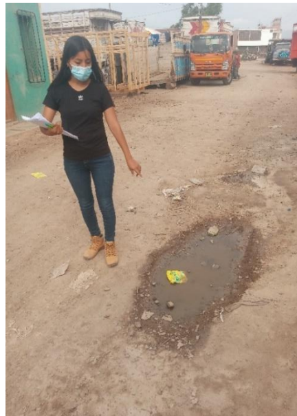
Figura 7. Empozamiento de agua residual
