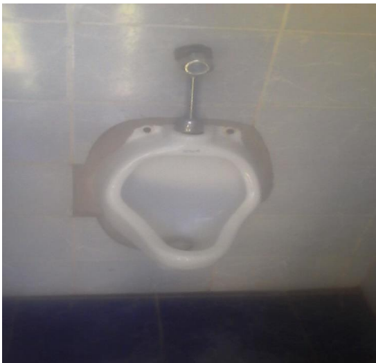
Urinario deteriorado con escape constante de agua.
