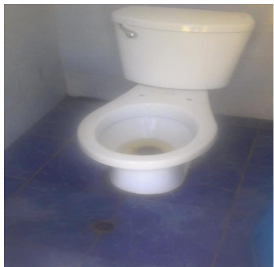
Baños en mal estado con escape de agua
