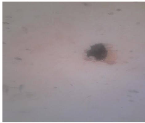
Techos del comedor con agujeros
