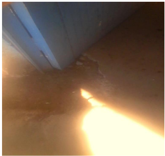
Piso de la cocina deteriorado
